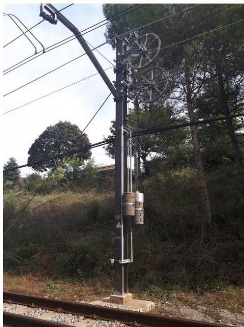
Sistema de compensació doble ECP-2 a la sortida de l'estació de La Pobla de Claramunt
