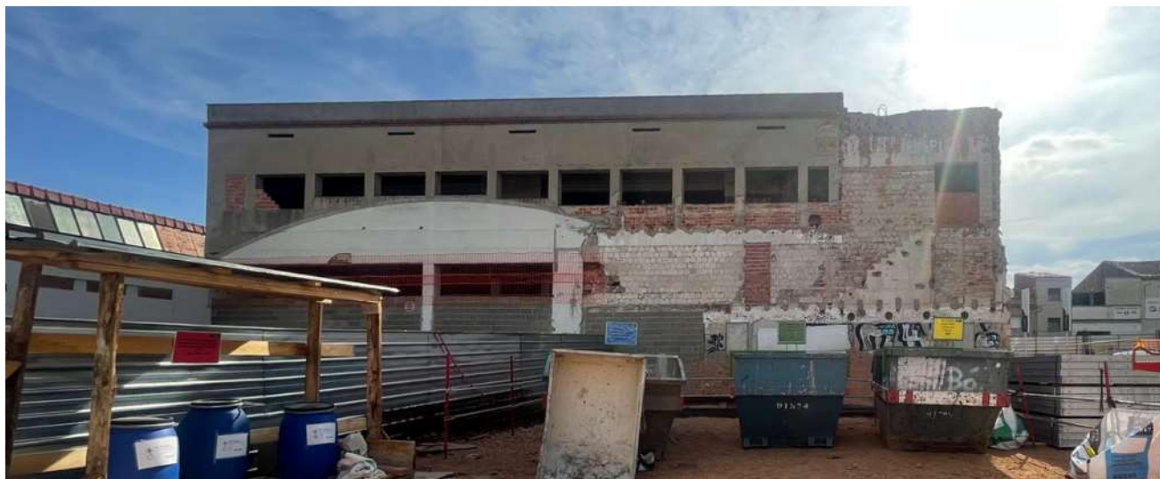
Fig. 32: Imatge actual de l'edifici torre vist per l'interior d'illa. S'observa l'estat de deteriorament i la manca de tancaments.
