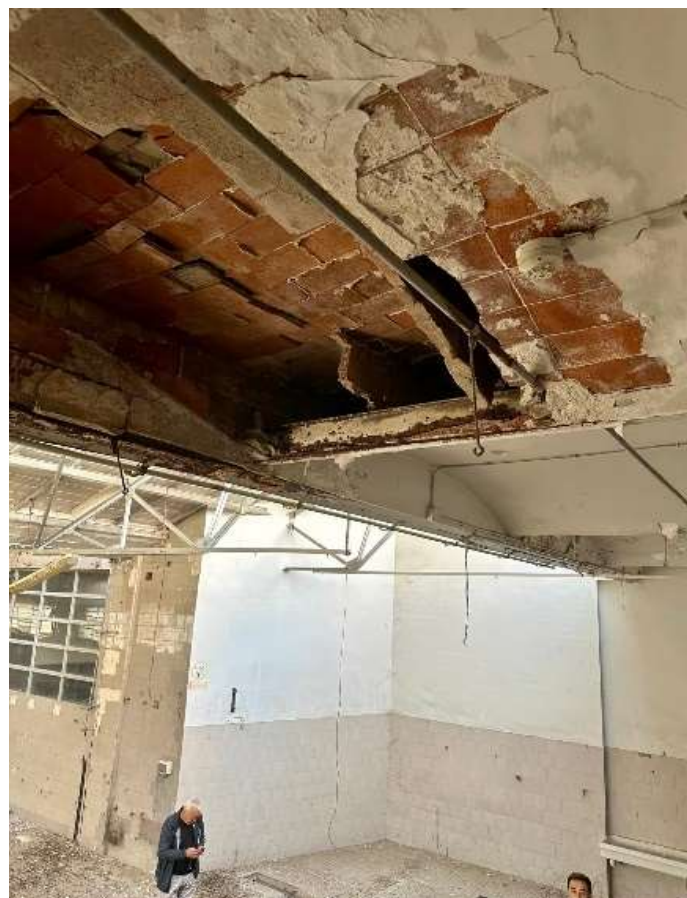
Fig. 15: Imatge d'un tram de forjat en planta primera on la volta entre perfils a col·lapsat i on es veuen els perfils amb un atac d'òxid avançat
