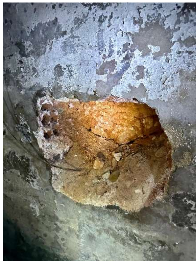
Fig. 12: Imatge de detall d'un forat en un dels murs on es veu que està compostat per un full de totxana (maó foradat).
