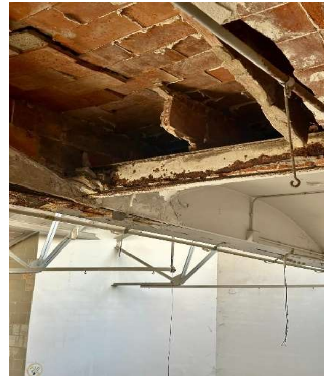
Fig. 11: Imatge de detall d'una estructura metàl·lica que recolza sobre el cordó de l'encavallada principal amb una afectació important per corrosió
