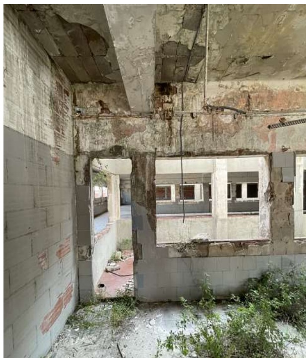
Fig. 39: Imatge de l'interior de la planta primera de l'edifici torre. S'observa la desaparició de la totalitat d'elements de divisió i tancament amb el consegüent deteriorament.
