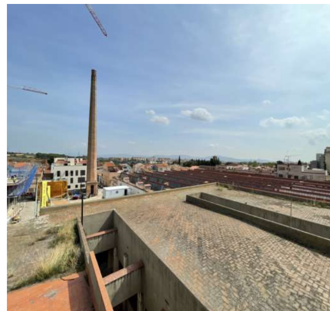
Fig. 20: Imatge de l'estat general de les cobertes planes de l'edifici torre, amb vegetació a les juntes per falta de manteniment
