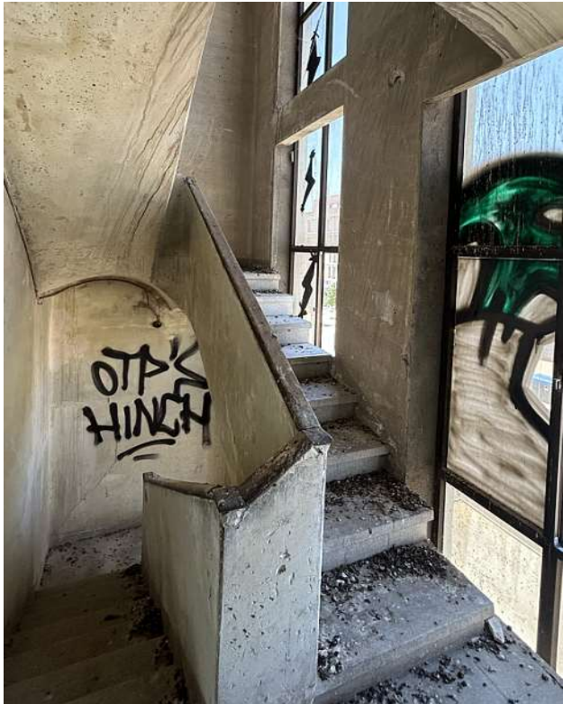
Fig. 49: Estat de l'escala principal de l'edifici torre.
