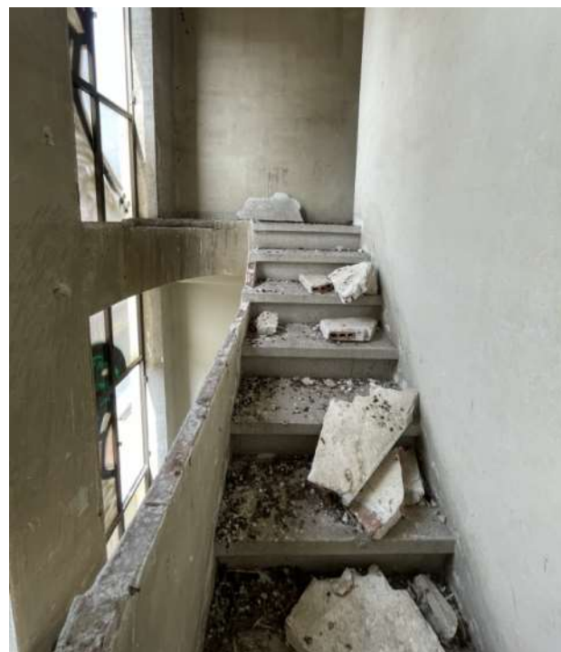
Fig. 40: Imatge de l'escala interior principal de l'edifici torre. S'observa la desaparició de fusteries exteriors, graonat, baranes de protecció etc.
