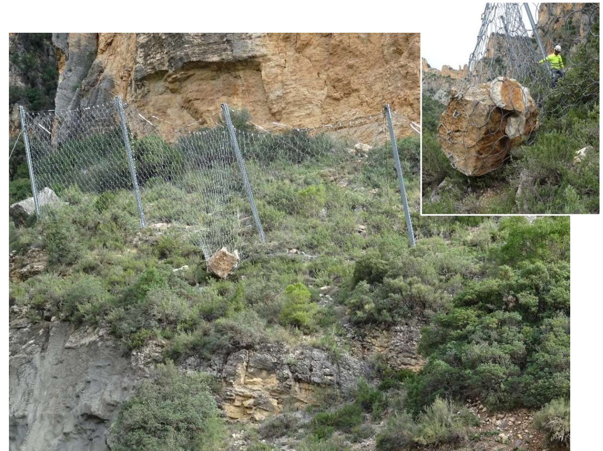
Figura 2. Vista de la zona de l'impacte del bloc a la barrera.
