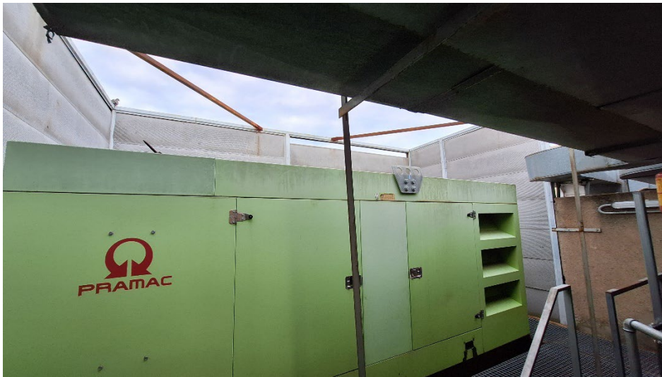
F5. Grup electrògen, a la coberta del Palau Aguilar
