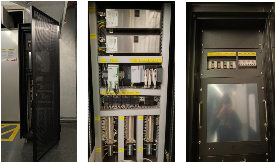
Figura 3: Representació del rack de comunicacions i dels equips del seu interior.
