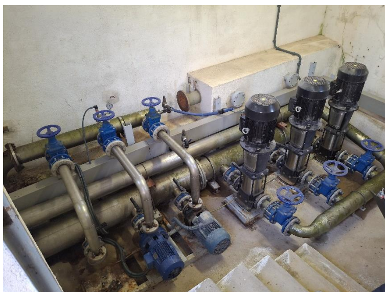
Interior de la caseta (equips mecànics)
