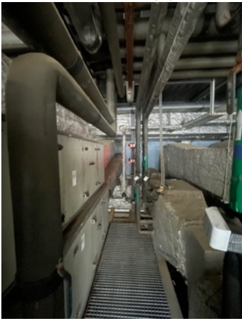
Passarel·les, conductes i equips
