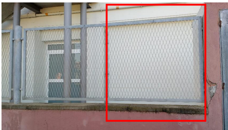
Figura 13. Estai previst per a la col·locació de l'armari de la TMF de generació en previsió a un autoconsum col·lectiu.
