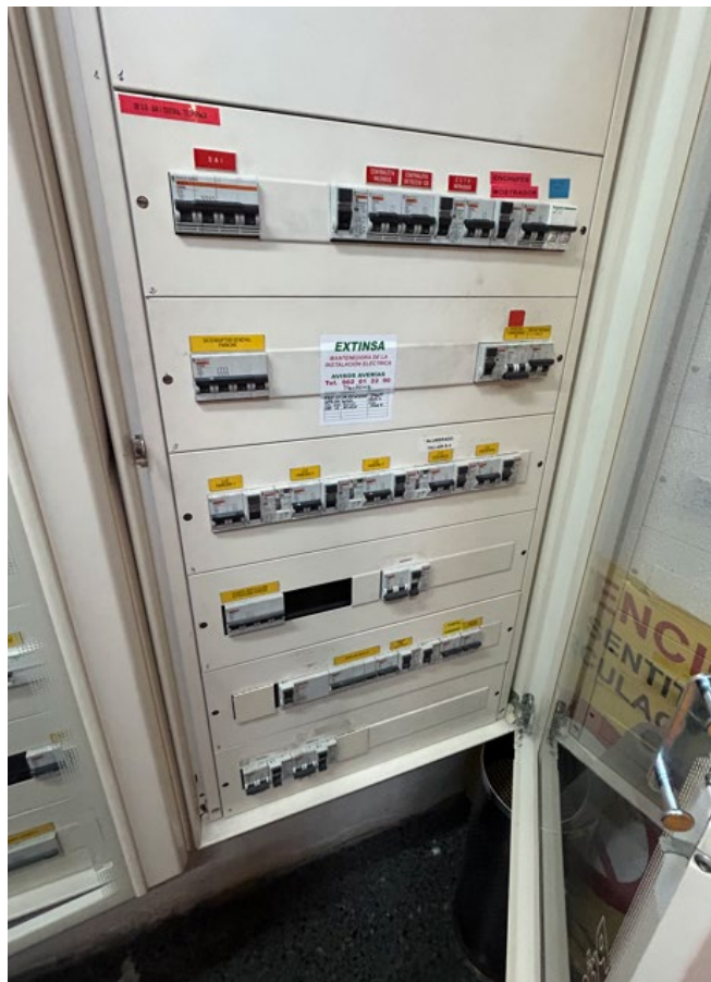
Figura 8: Quadre elèctric a la planta -2 on es realitzarà l'escomesa de les recàrregues elèctriques emprant els circuits i espais de reserva del quadre.
