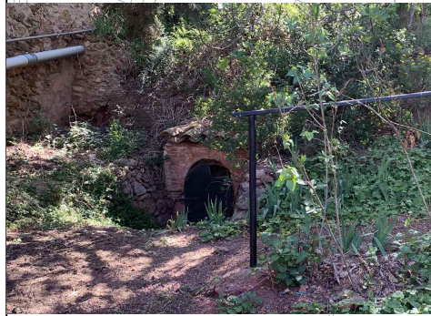
FOTO 01- PORTA D'ACCÉS MINA AFECTADA
