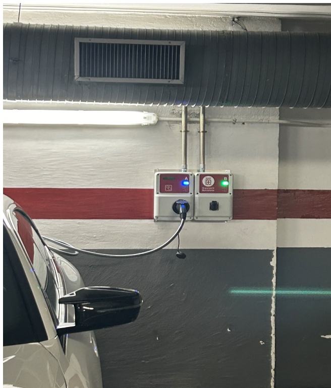
Figura 9: carregadors instal·lats actualment a planta -3 i -4
