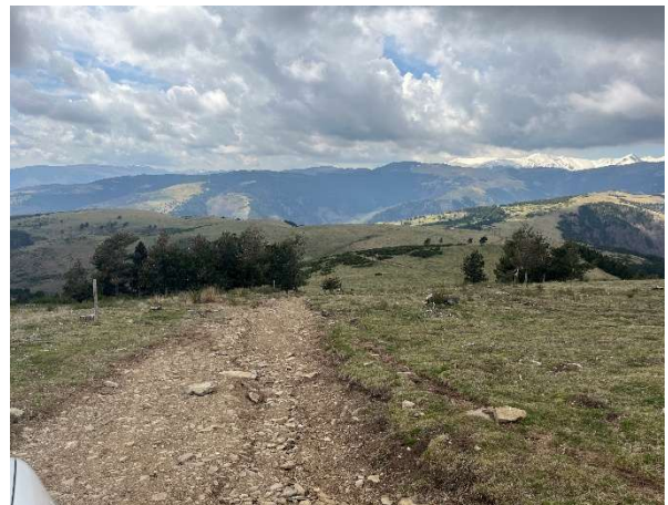
Foto 4: Ferm del camí erosionat (Font: Montserrat Solanelles Ubach).
