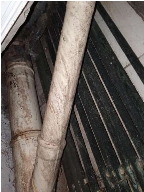
Pati Instal·lacions Baixos 2a
