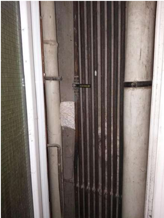
Pati Instal·lacions 5e 1a
