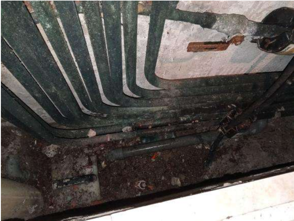
Pati Instal·lacions Baixos 2a
