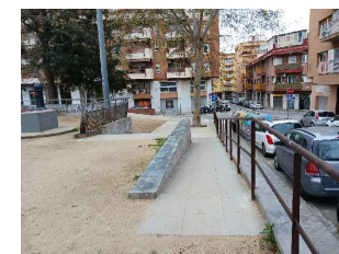
V39 APLACAT/REVESTIMENTS MALMESOS AFECTACIÓ ORINS TANCA OXIDADA/TRENCADA
