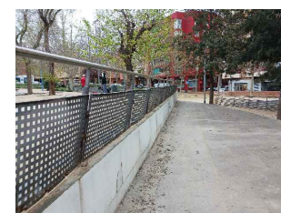
V30 APLACAT/REVESTIMENTS MALMESOS MUR MALMÉS/COBREMUR TRENCAT TANCA OXIDADA/TRENCADA
