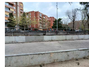
V29 APLACAT/REVESTIMENTS MALMESOS MUR MALMÉS/COBREMUR TRENCAT TANCA OXIDADA/TRENCADA
