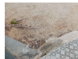
V17 PAVIMENTS MANCA ACCESSIBILITAT
