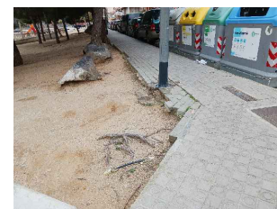
V8 VORERA TRENCADA AFECTACIÓ D'ARRELS
