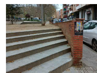
V37 AFECTACIÓ PER ORINS MUR MALMÉS/COBREMUR TRENCAT PAVIMENT DE SAULÓ EN MAL ESTAT
