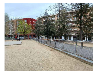
V25 APLACAT/REVESTIMENTS MALMESOS MUR MALMÉS/COBREMUR TRENCAT TANCA OXIDADA/TRENCADA
