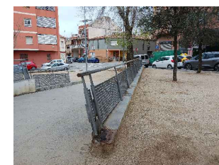
V15 CANTONADA MUR MALMESA ORINS BARANA TRENCADA
