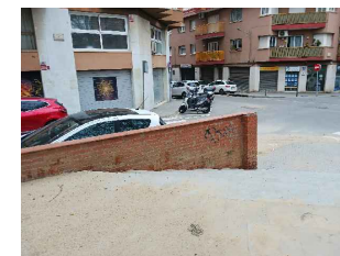
V35 AFECTACIÓ PER ORINS MUR MALMÉS/COBREMUR TRENCAT PAVIMENT DE SAULÓ EN MAL ESTAT
