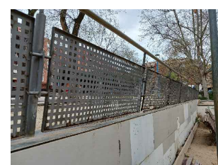
V26 APLACAT/REVESTIMENTS MALMESOS MUR MALMÉS/COBREMUR TRENCAT TANCA OXIDADA/TRENCADA
