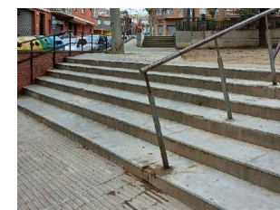
V38 APLACAT/REVESTIMENTS MALMESOS AFECTACIÓ ORINS TANCA OXIDADA/TRENCADA
