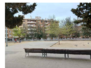
V13 FORMACIÓ DE GRAÓ PER MANCA DE MANTENIMENT PAVIMENT DE SAULÓ RENATURA - ENDERROC PAVIMENT
