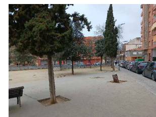
V14 FORMACIÓ DE GRAU PER MANCA DE MANTENIMENT PAVIMENT DE SAULÓ RENATURA - ENDERROC PAVIMENT
