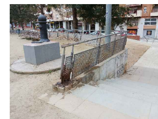
V20 CANTONADA MUR MALMESA ORINS BARANA TRENCADA/OXIDADA FONT NO ACCESSIBLE
