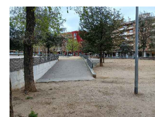
V18 CANTONADA MUR MALMESA ORINS BARANA TRENCADA
