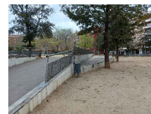
V28 APLACAT/REVESTIMENTS MALMESOS MUR MALMÉS/COBREMUR TRENCAT TANCA OXIDADA/TRENCADA
