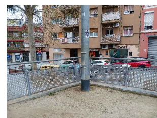
V21 TANCA OXIDADA/DEGRADADA XAPA PERFORADA EN MAL ESTAT AFECTACIÓ ORINS
