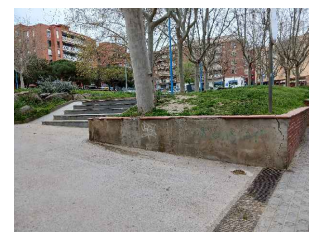
V2 MUR ESQUERDAT COBREMUR TRENCAT ESCALA/RAMPA SENSE BARANA
