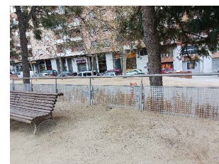
V22 TANCA OXIDADA/DEGRADADA XAPA PERFORADA EN MAL ESTAT MANCA MANTENIMENT PAVIMENT SAULÓ
