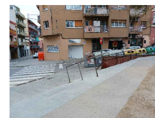
V36 APLACAT/REVESTIMENTS MALMESOS AFECTACIÓ ORINS TANCA OXIDADA/TRENCADA
