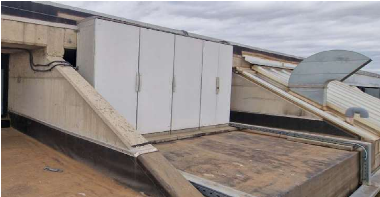
Imatge 79. Subquadre ventiladors coberta espina C
