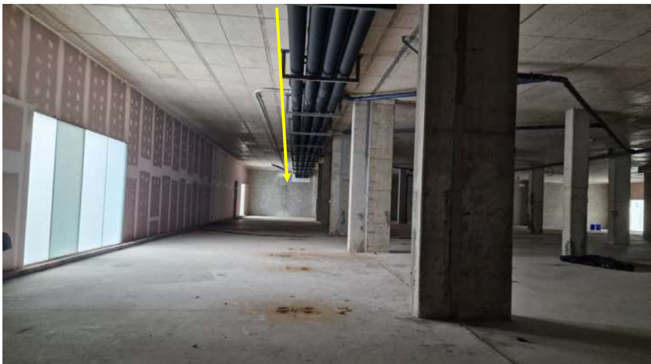
Imatge 72. Cablejat de CA per futur espai d'hemodiàlisis
