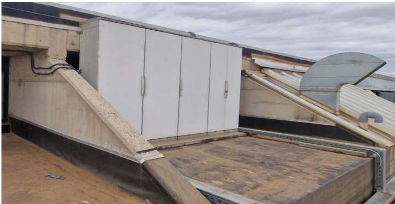
Imatge 79. Subquadre ventiladors coberta espina C
