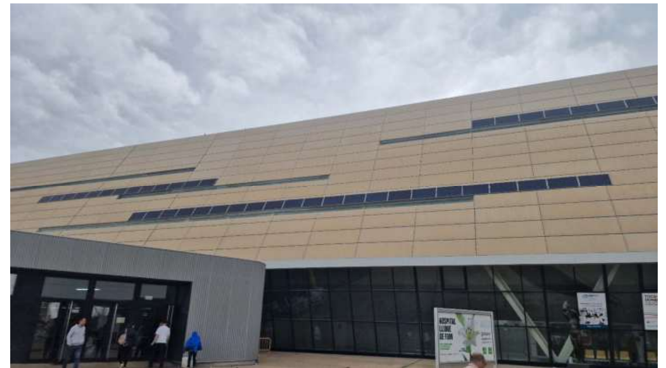
Imatge 3. Vista de la instal·lació fotovoltaica existent a la façana
