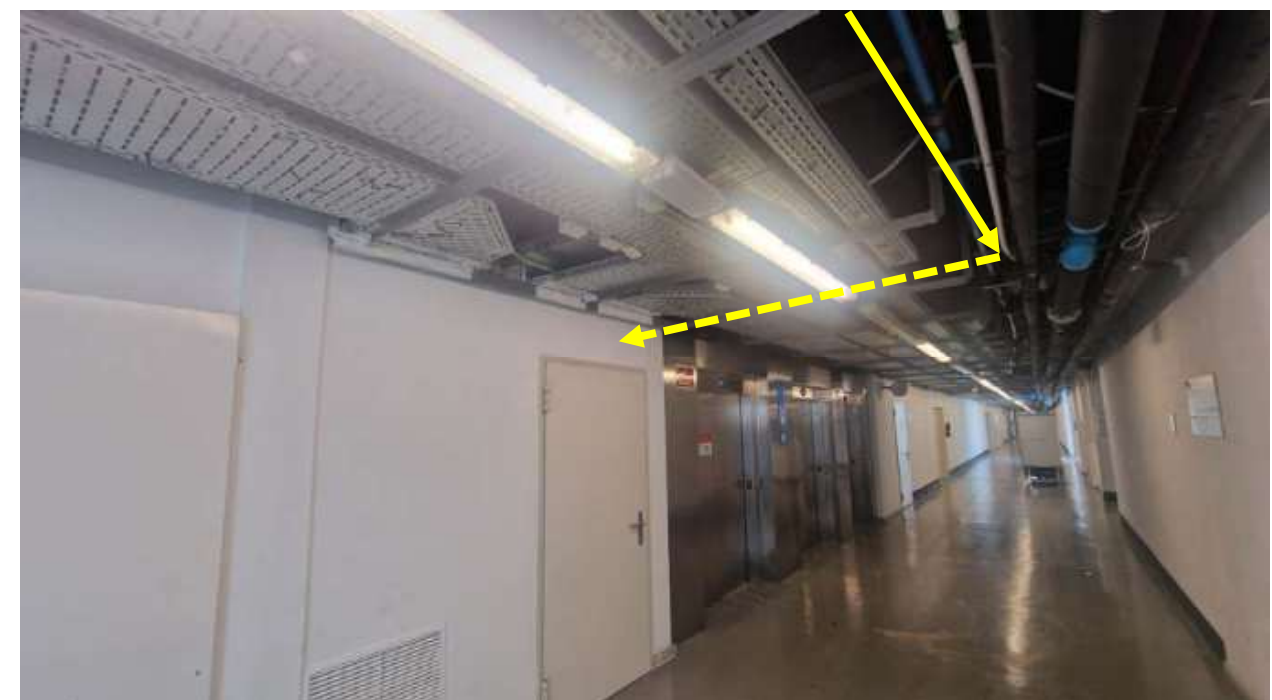
Imatge 55. Passadís d'espai tècnic a la ET1
