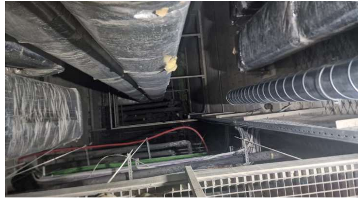
Imatge 54. Baixant de planta tècnica a soterrani
