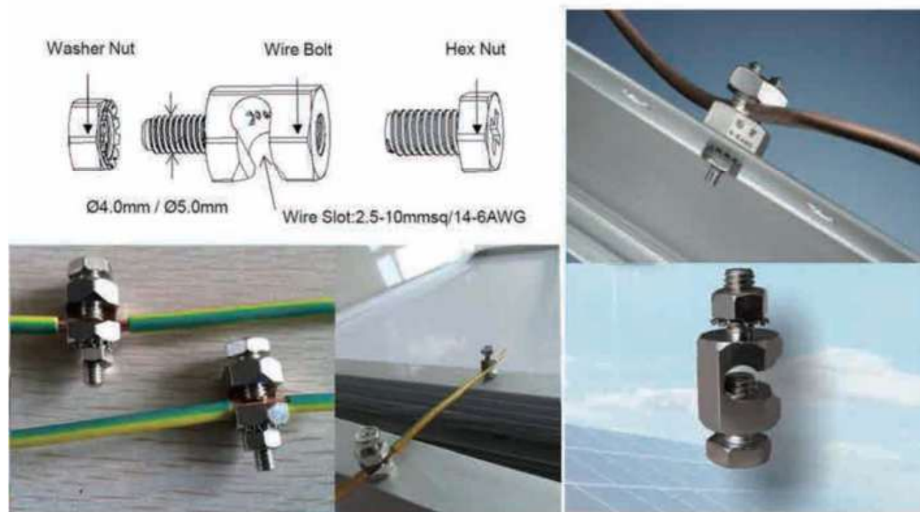
Imatge 90. Exemple d'unió de cablejat entre mòduls
