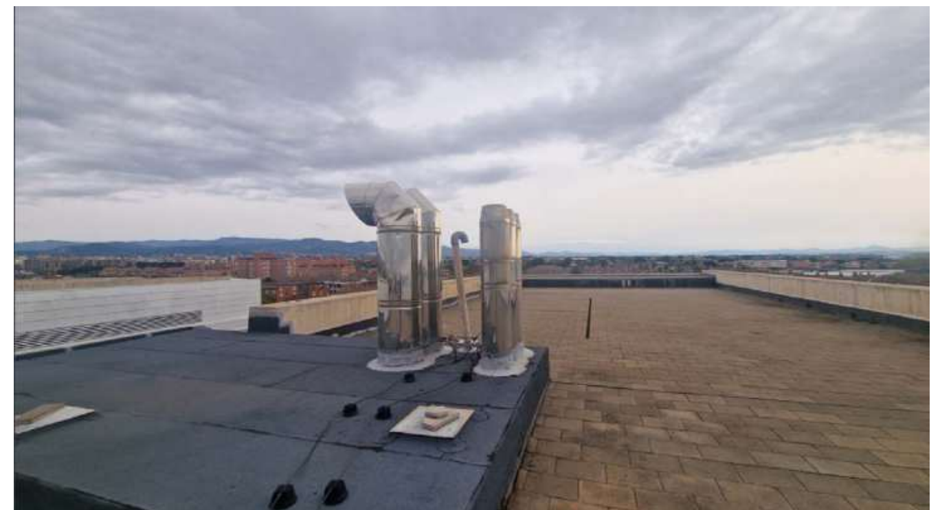
Imatge 102. Zona lliure de línia de vida per mur perimetral
