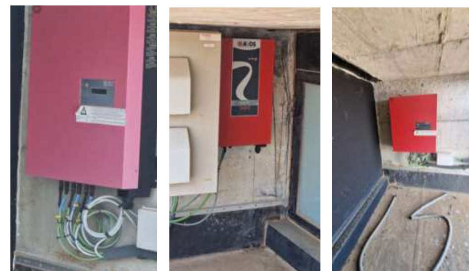
Imatge 78. Imatge d'alguns dels inversors existents
