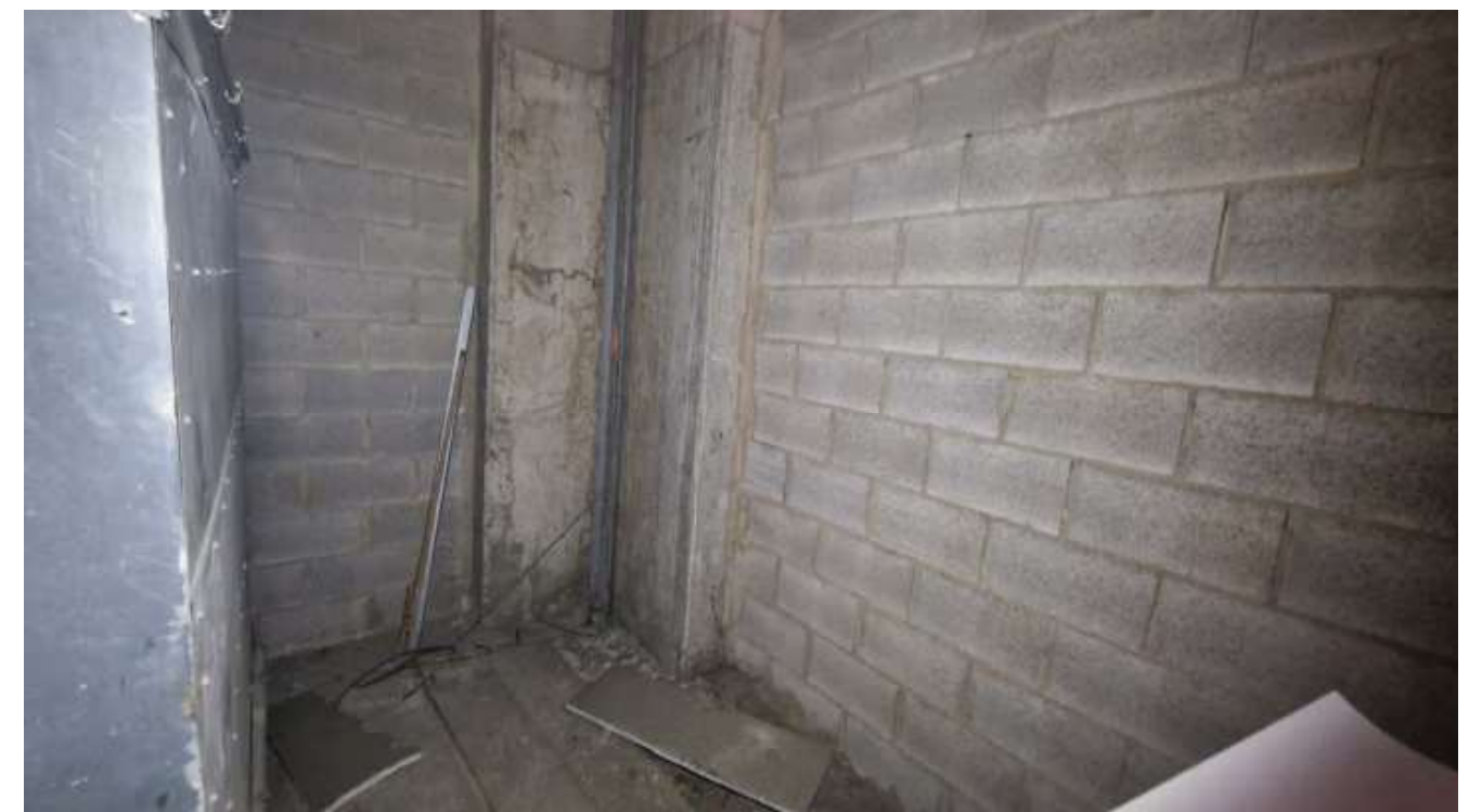
Imatge 8. Espai en la sala tècnica de l'edifici de Gerència
