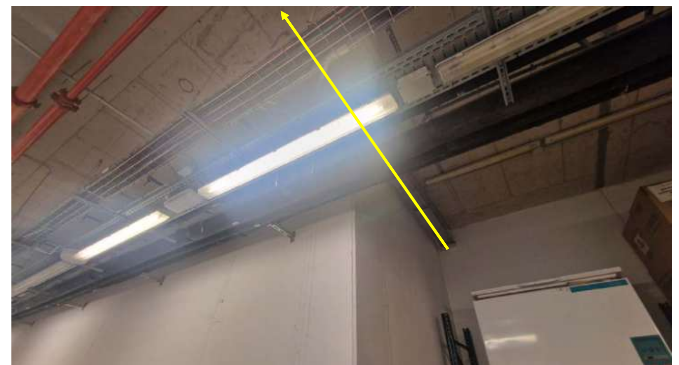
Imatge 71. Entrada cablejat a passadis de serveis provinent de l'aparcament
