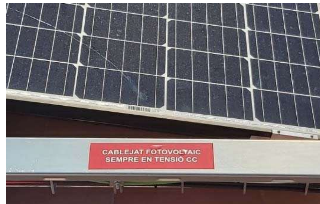
Imatge 81. Exemple de safata metàl·lica per cablejat de CC
