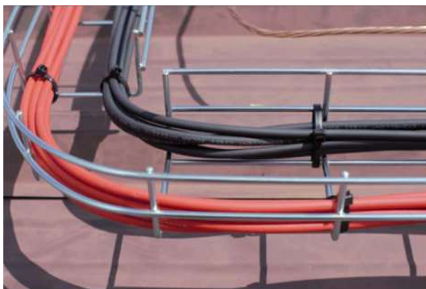
Imatge 84. Separació de cablejat per polaritat, previ a la col·locació de la tapa de la safata
