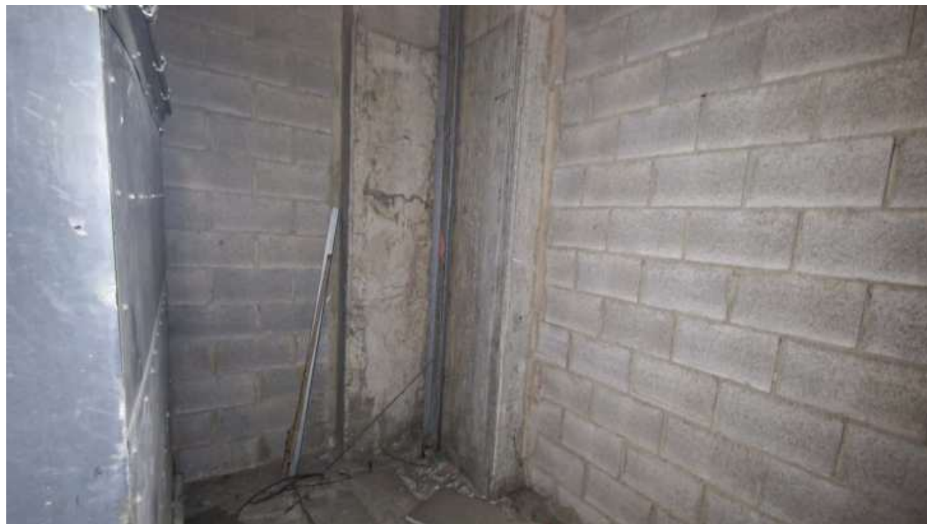
Imatge 69. Sala pendent d'obres on s'emplaçaran els inversors i les caixes de protecció de CC i CA
