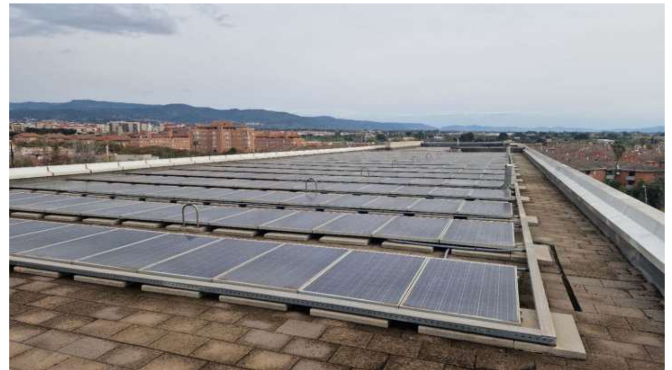
Imatge 4. Imatge de la instal·lació fotovoltaica existent a la coberta, i que es preveu desmuntar
