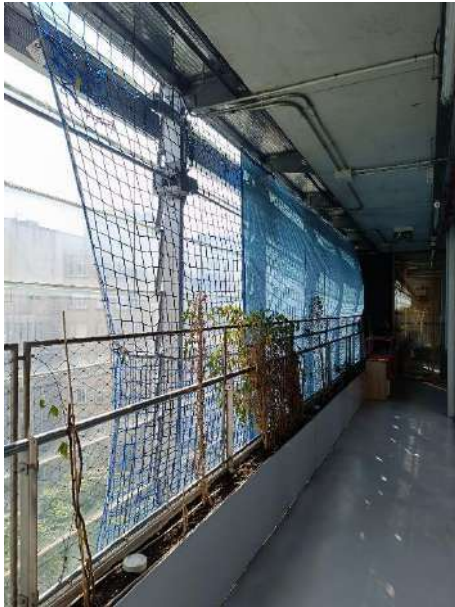
Zona afectada (Planta Tercera)
