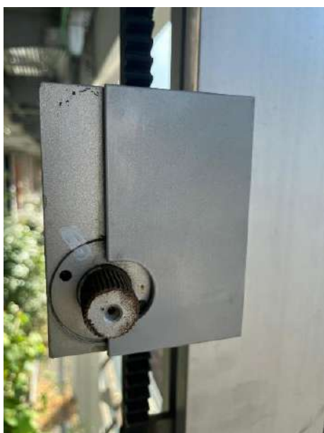
Tapes laterals en caixa de transmissió
