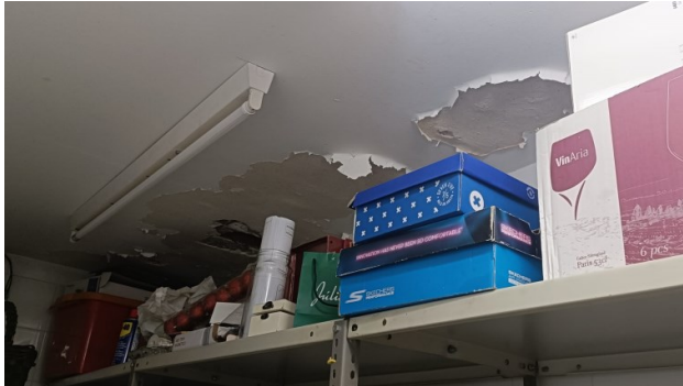
Humitats a la paret mitgera de l'habitatge del carrer del Pont 73. Planta baixa
