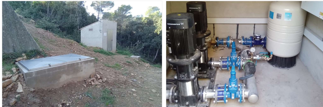
Imatges 13 i 14. Vista interior de l'estació de bombament de Sa Riera
