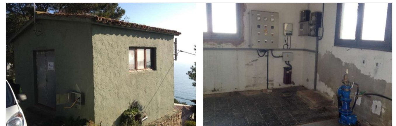
Imatge 26. Vista exterior i interior de l'estació de bombament La Borna
