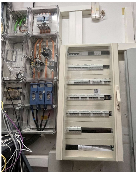
Figura 16 Ubicació escomesa existent que allotja la TMF-10 consum al costat del QGBT.
