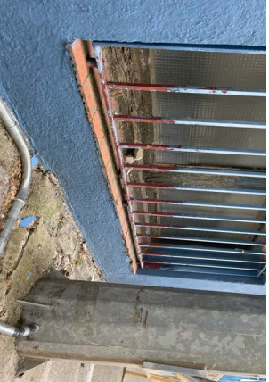
Paviment i lusteries – falta de minvellis
