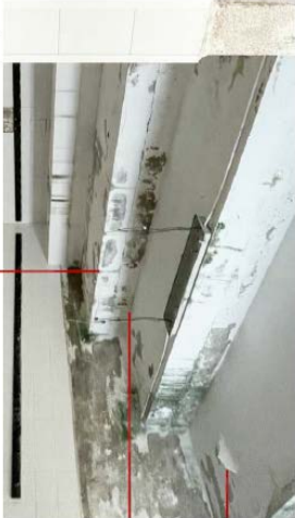
DESPEINAMENT DE PINTURA EN PARETS I SOSTRES DEGUT A L'HUMIDAT
