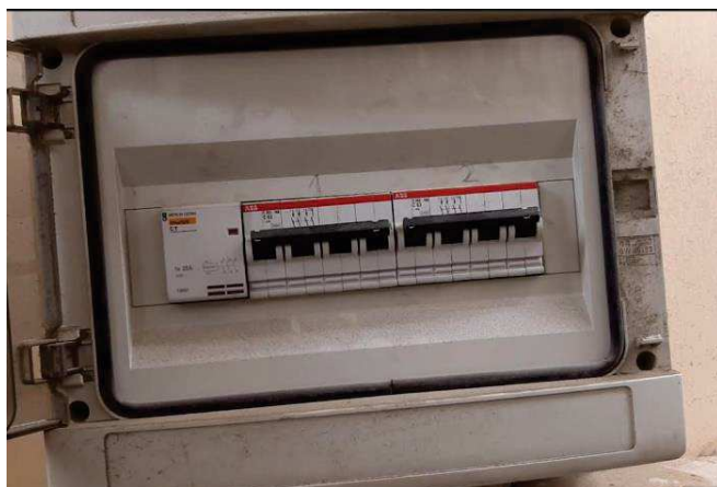
Subquadre elèctric alimentació de les dues bombes calor aire/aire
