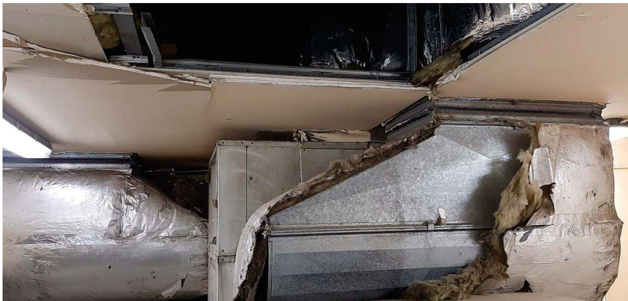
Vista frontal de les dues bombes de calor aire/aire de 50 kW que s'han de retirar. El fals sostre acústic de la sala també s'haurà de treure.
