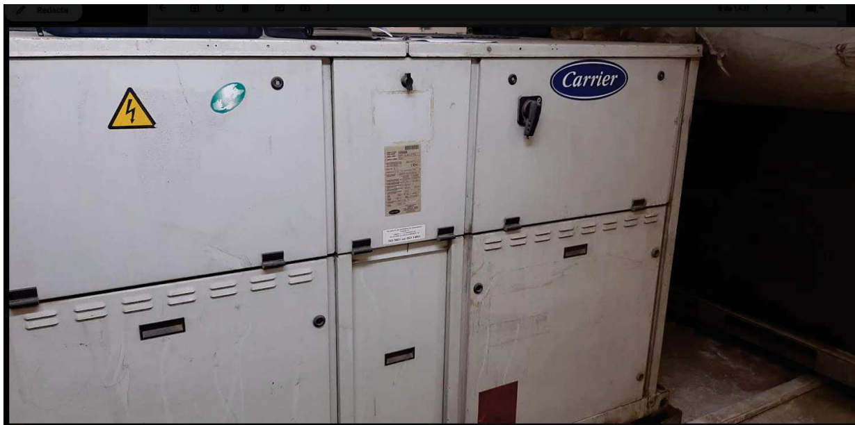
Unitat refredadora aire/aigua de 135 kW existent a retirar.
