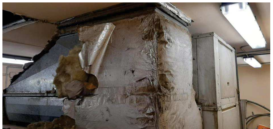
Bomba de calor compacta 1 aire/aire de 50 kW i conductes. Hi ha dues unitats com aquesta a dins del local que s'han de retirar.
