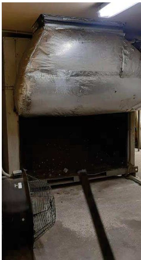
Bomba de calor 2 aire/aire de 50 kW i equip de ventilació sala a retirar.
