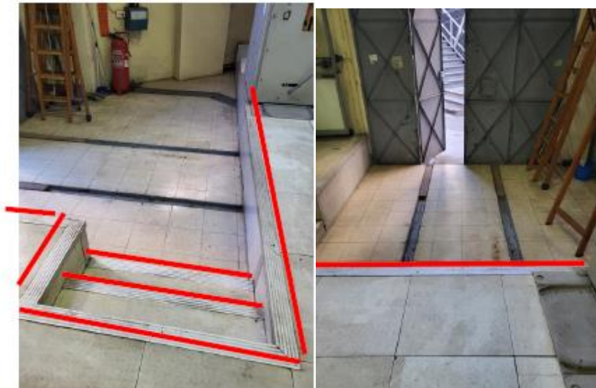
Imatge 27 Desnivell subestació Sarrià
