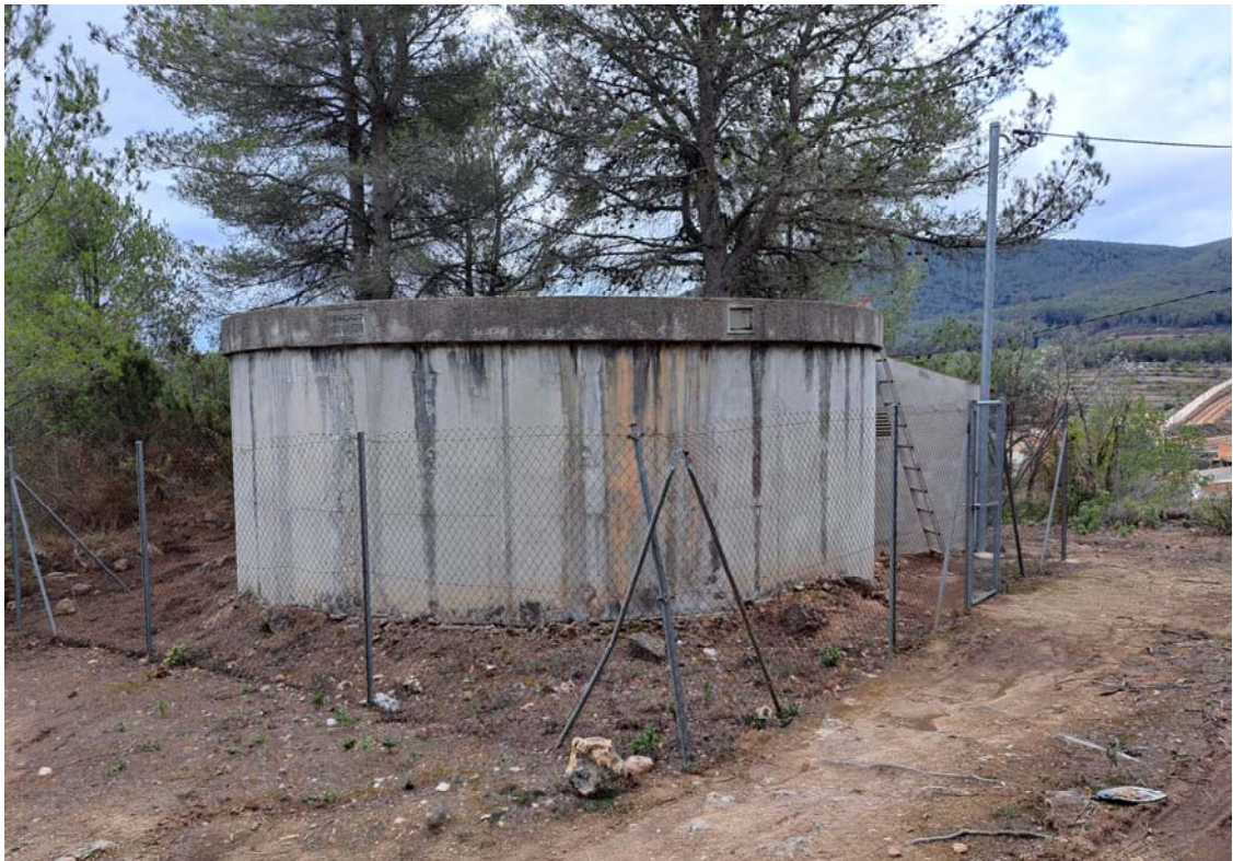
3. Dipòsit 2 del Pla de Manlleu (capçalera i distribució)
