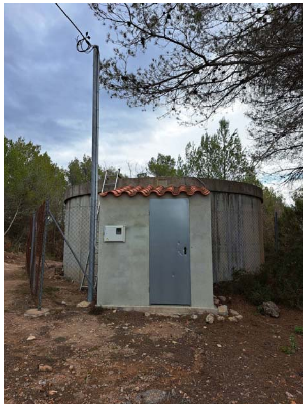
4. Dipòsit 2. Caseta de quadre elèctric i cloració
