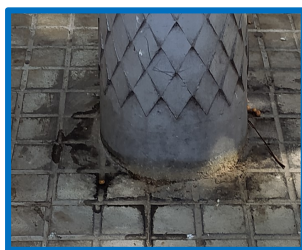
Estat 9: Signes de corrosió. Consistència dura.
