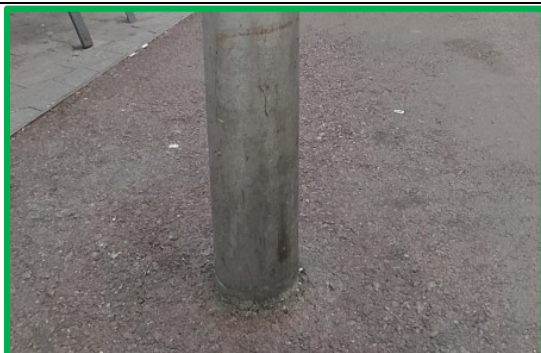
Estat 8: Columna recte, sense entollament, sense orins, entrega del paviment correcte No es veu l'encastament.
