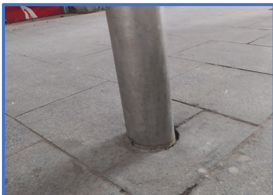
Estat 9: Entrega deficient del paviment.
