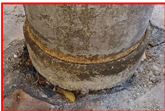
Suport en estat 10 – Entrega paviment defectuosa. Entollament d'aigua. Pèrdua de material de l'anell d'encastament.
