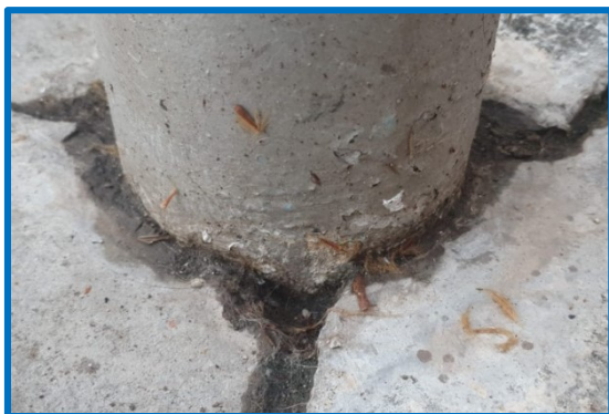
Estat 9: Acumulació orina, entrega deficient del paviment.
