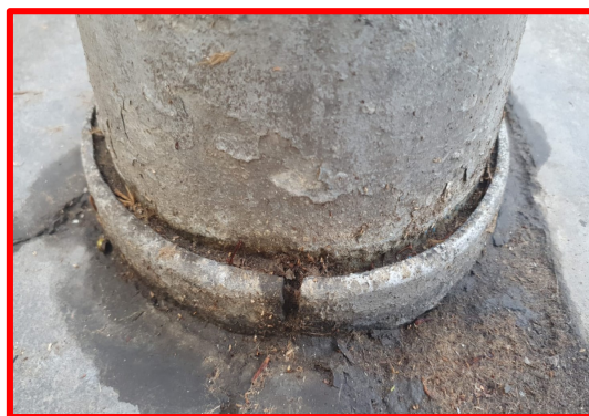
Suport en estat 10 – Anell de l'encastament trencat.
