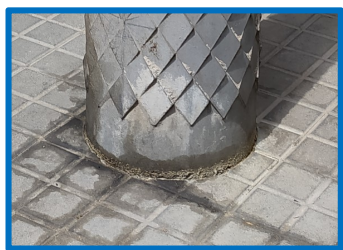
Estat 9: Signes de corrosió. Consistència dura.
