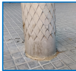
Estat 9: Signes de corrosió. Lleugera pèrdua de material al rascar amb tornavís.
