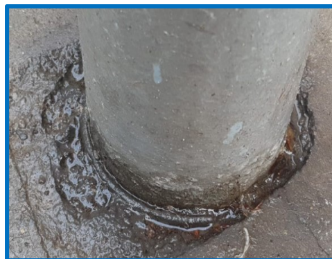
Estat 9: Acumulació orina, entrega deficient del paviment.
