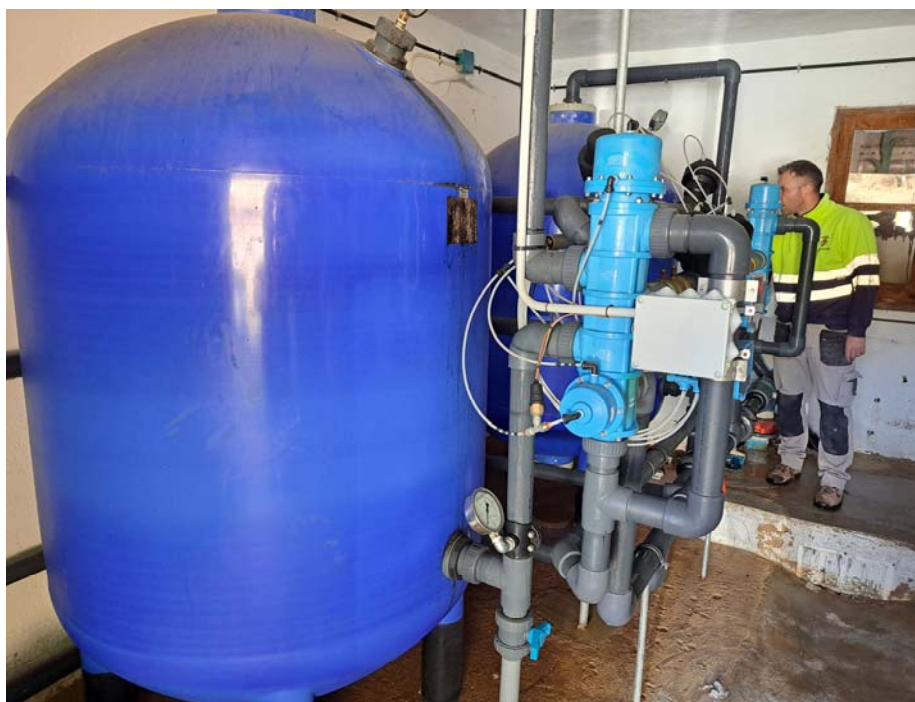
2 Vista general del sistema de filtració de l'E.T.A.P. de Prades, objecte d'actuació de substitució del material filtrant dels filtres (filtres de sorra)
