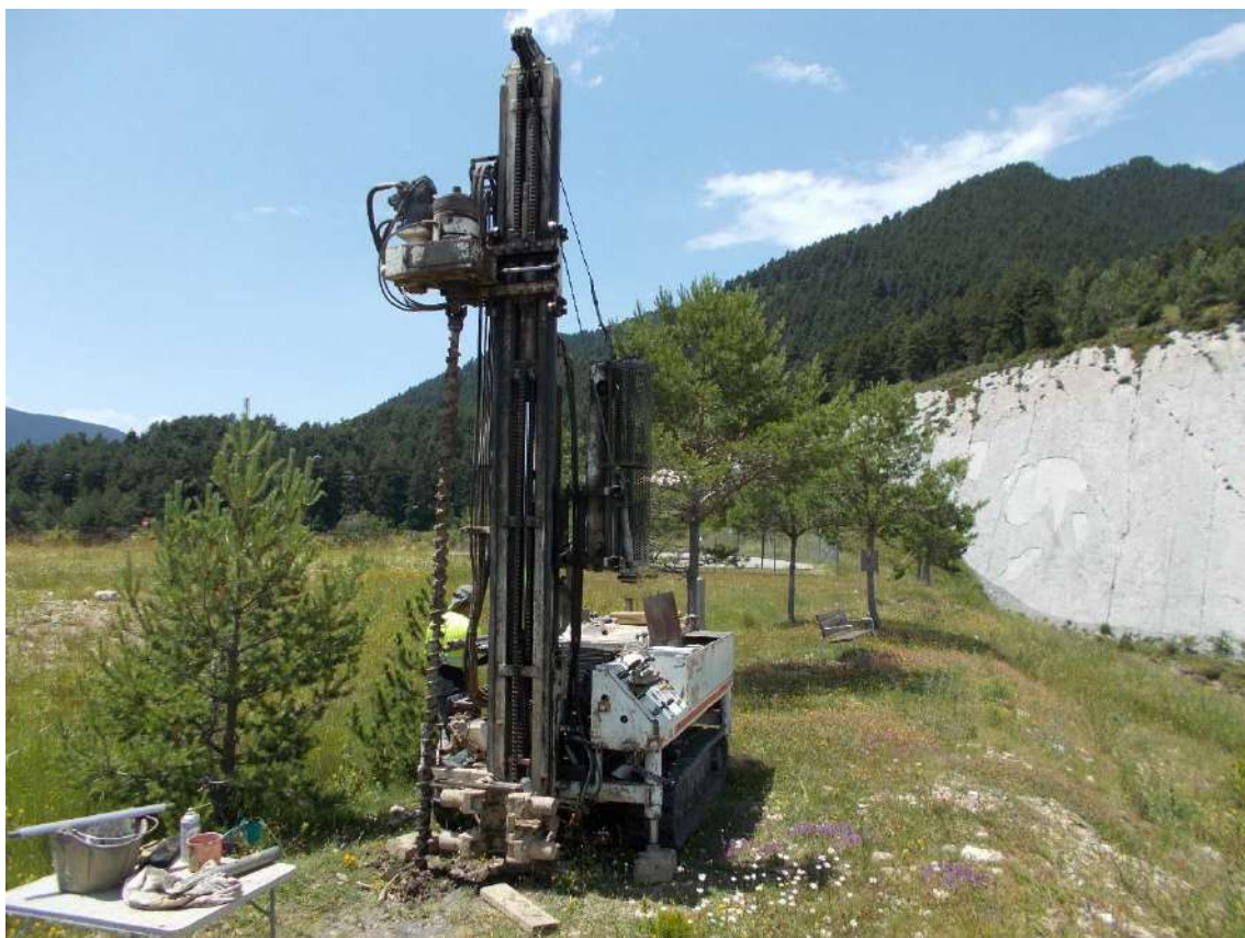
Emplaçament del cinquè sondeig, a dalt de tot del talús. En aquest sondeig es pot observar que la totalitat del talús és de rebliments
