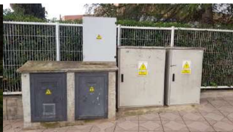
Localització quadre elèctric
