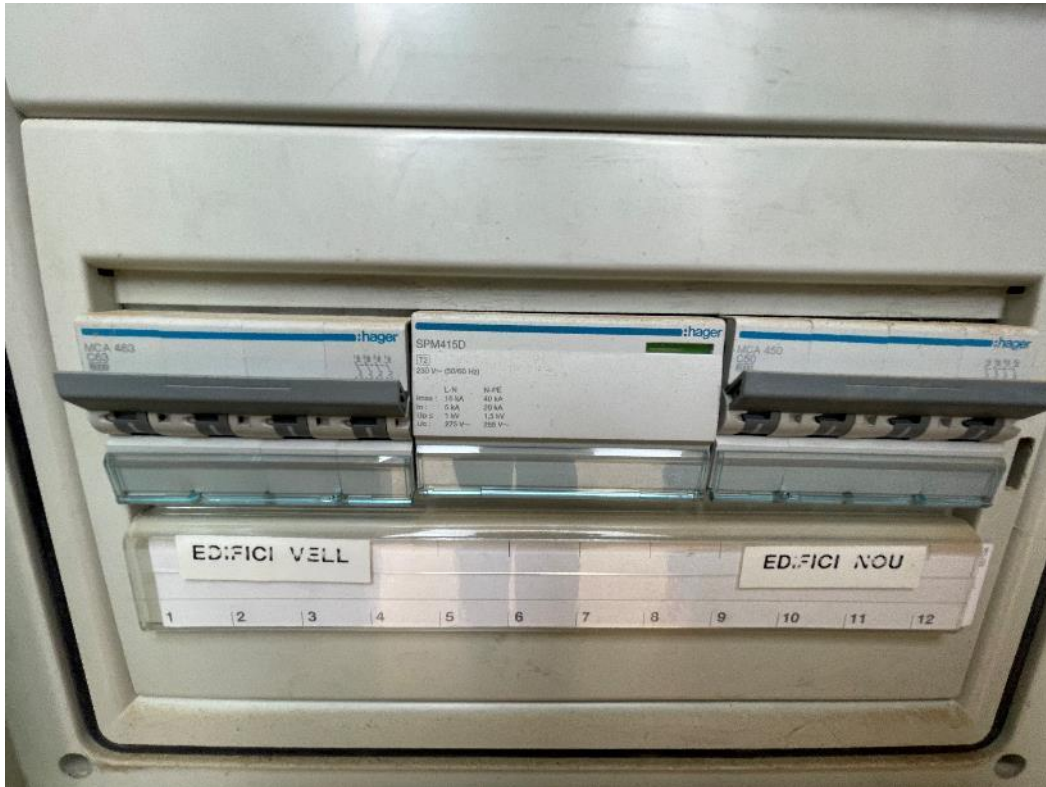
Fotografia 15: Detall dels diferents interruptors magneto tèrmics del quadra elèctric
