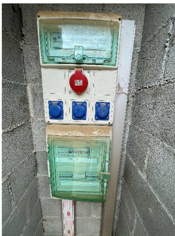
Fotografia 12: Detall del quadra elèctric
