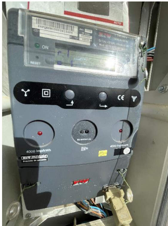
Fotografia 4: Comptador del subministrament elèctric
