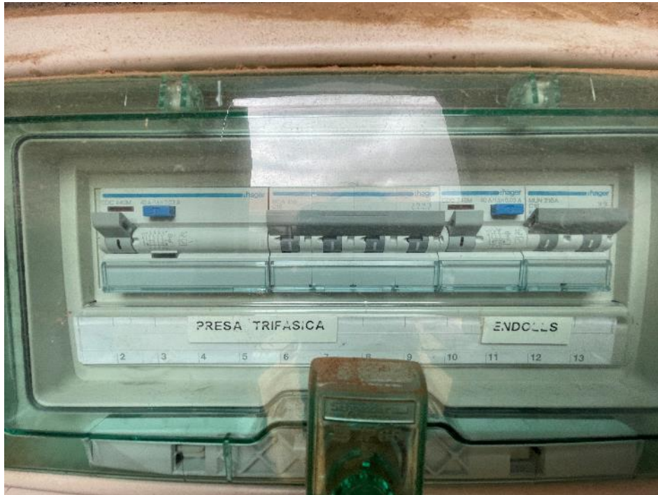
Fotografia 13: Detall dels diferents interruptors diferencials del quadra elèctric
