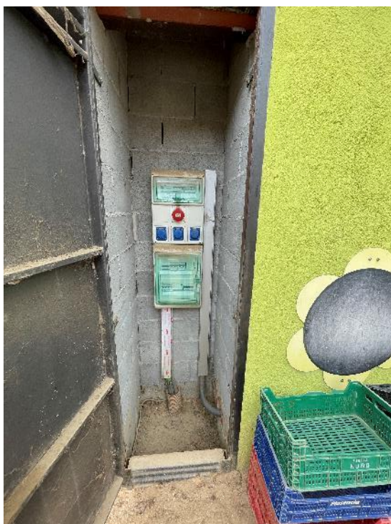
Fotografia 11: Estat actual del quadra de protecció elèctric
