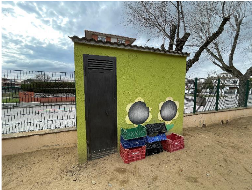
Fotografia 10: Estat actual del quadra elèctric per dintre l'escola
