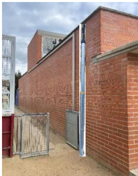
Imatge 3. Ubicació de tub d'acer baixant per on aniran els cables fins a l'armari TMF-10
