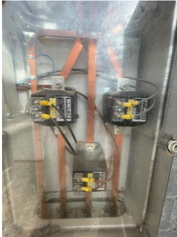
Fotografia 7: Estat actual de les 3 fases i neutre del subministrament elèctric
