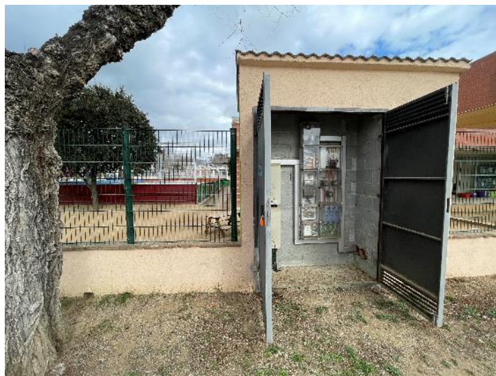
Fotografia 2: Estat actual del quadre elèctric de subministrament amb els seus components instal·lats
