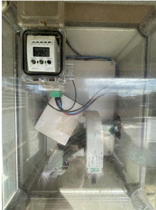
Fotografia 9: Transformador toroidal per al subministrament elèctric
