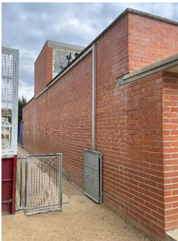
Fotografia 19: Estat actual de la canalització per on passen els cables elèctrics actualment
