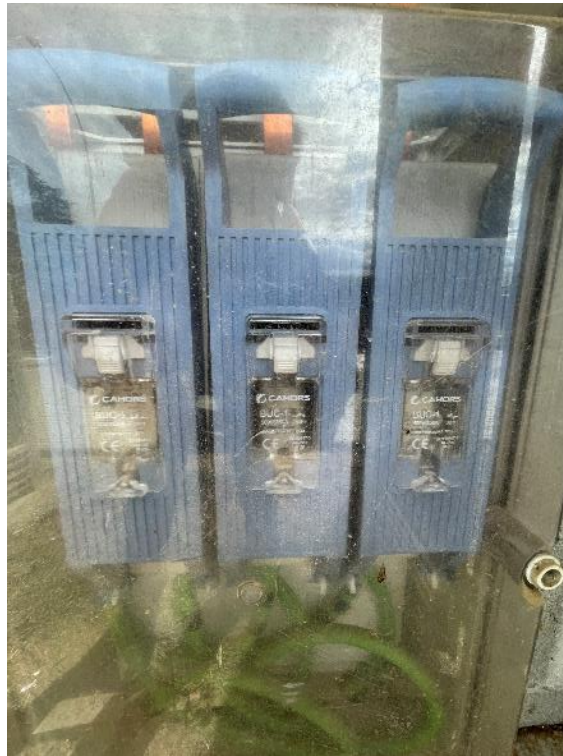
Fotografia 5: model de la caixa general de protecció
