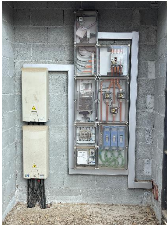
Fotografia 3: Detall dels components del quadra elèctric
