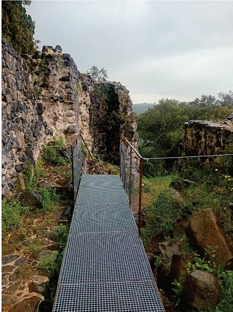
Exemple de cable d'acer galvanitzat per tal de delimitar el pas
