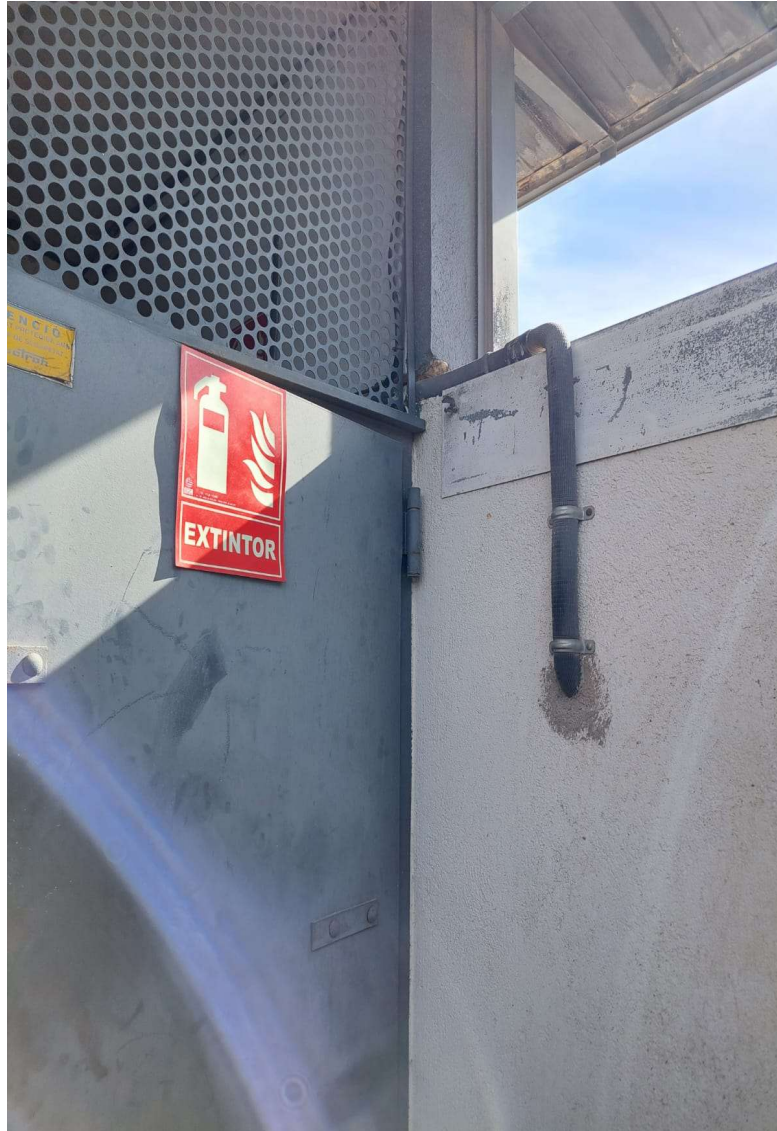
Imatge 7. Entrada existent del cablejat des de la CGP7 a l'exterior, i conducció cap a la TMF1 existent
