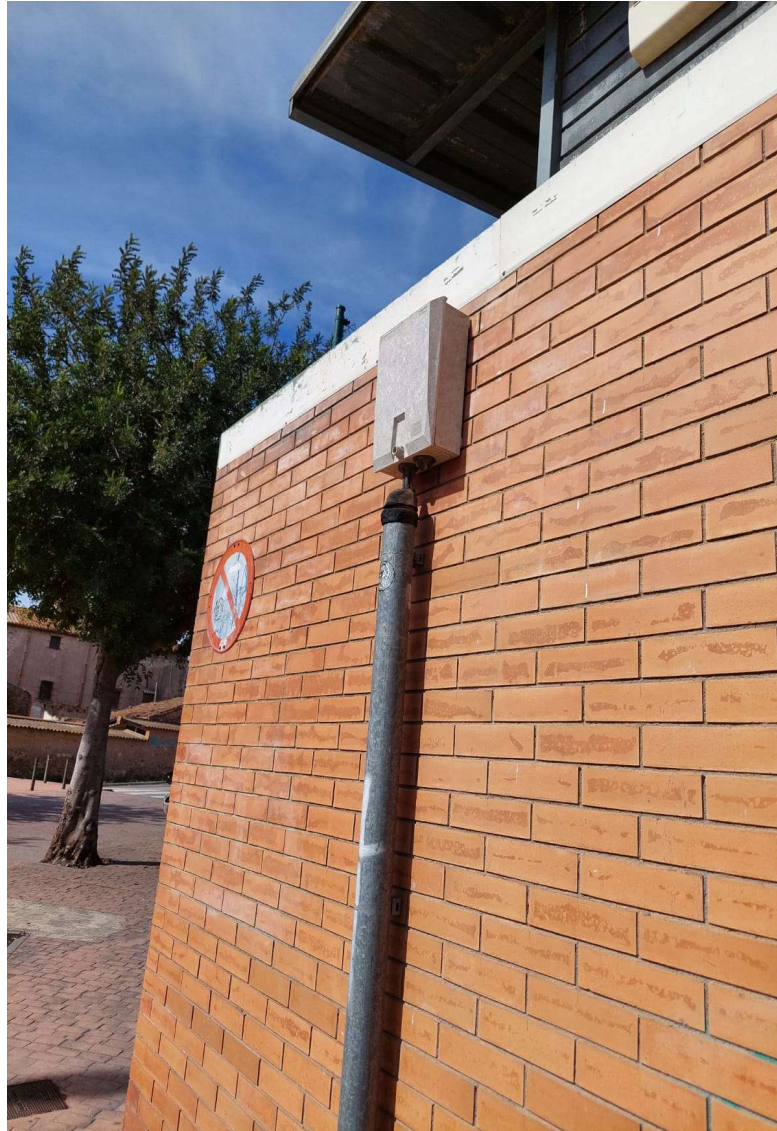
Imatge 8. CGP7 situada a l'exterior del recinte
