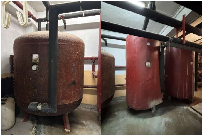
Il·lustració 4: dipòsits d'acumulació d'ACS 8.500L
