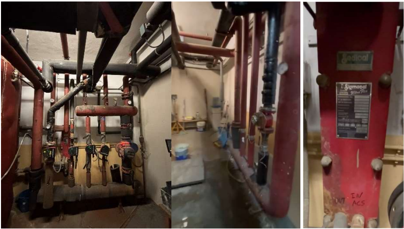
Il·lustració 3: col·lector d'impulsió, retorn i bescanviador de calor Sedical situat a la sala d'acumuladors d'ACS de planta baixa
