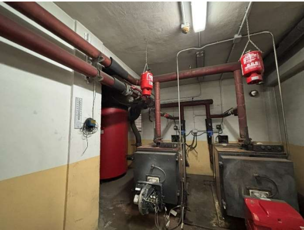
Il·lustració 2: generadors d'ACS i calefacció situats a la sala de calderes de planta baixa
