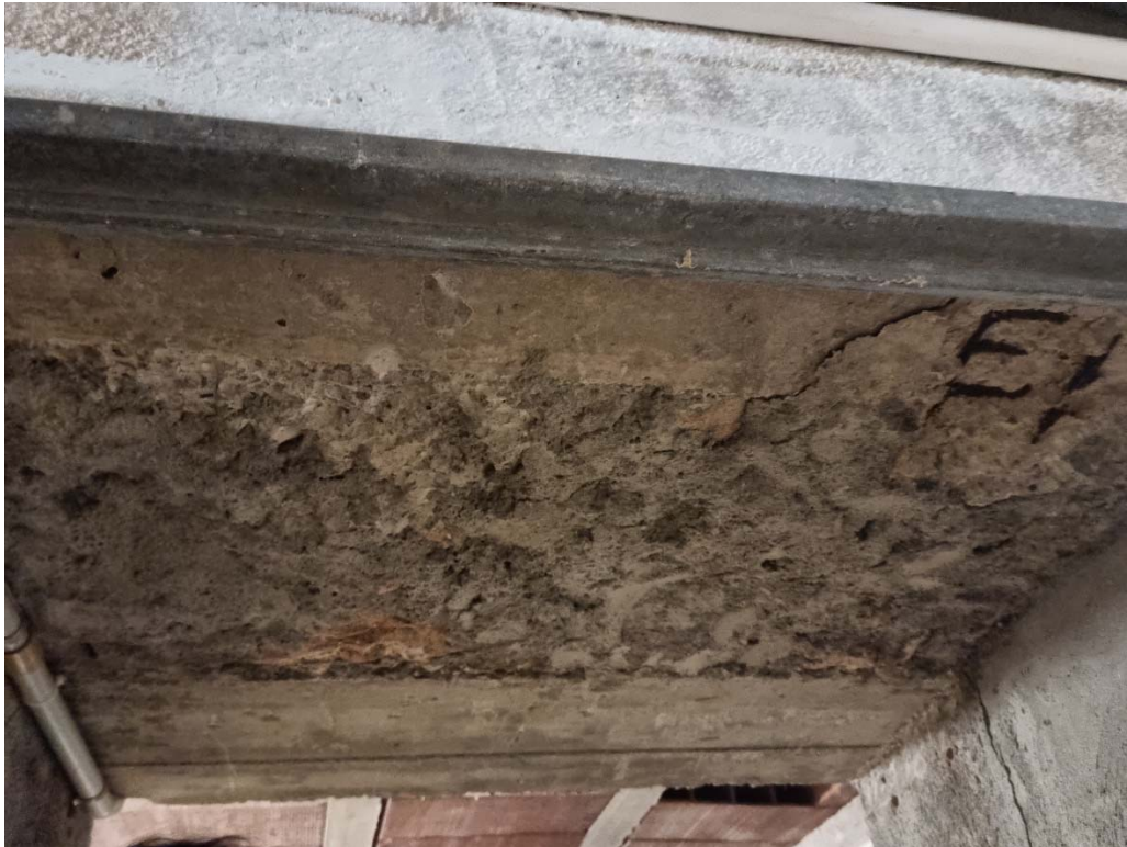
Humitats – Degradació per humitat en planta soterrani per manca d'estanqueïtat en la terrassa situada damunt.
