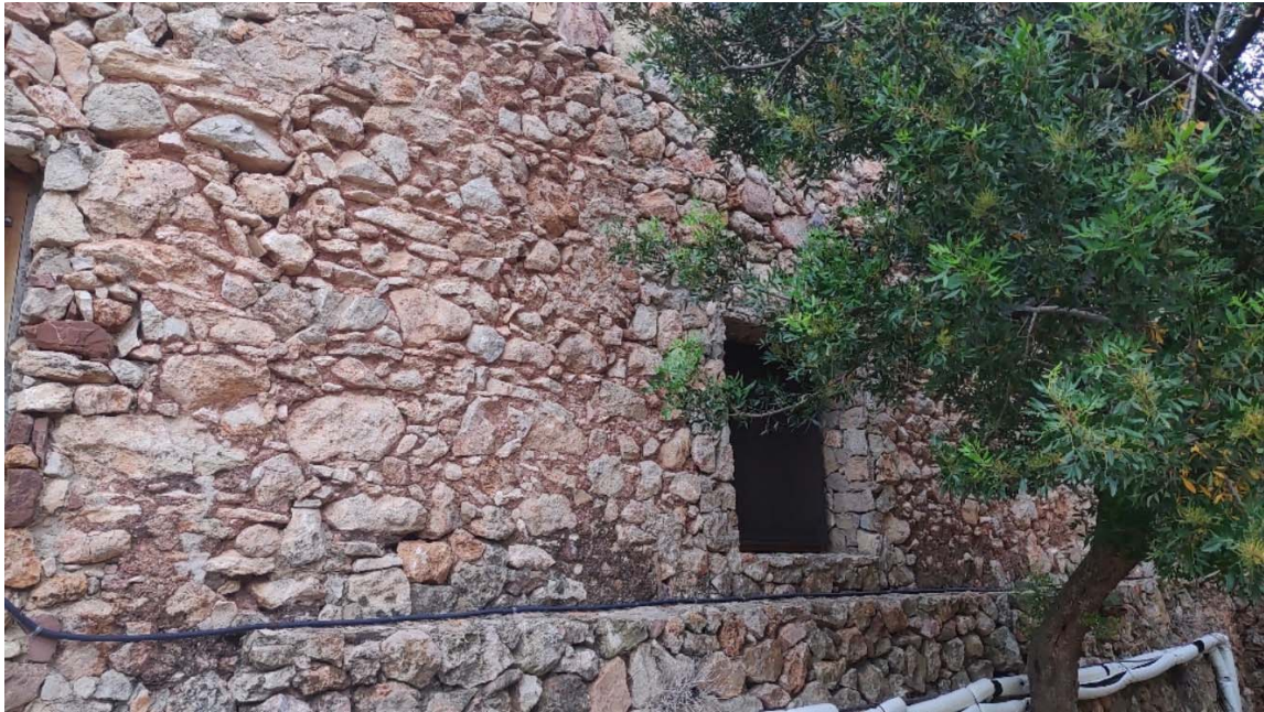
Vista exterior de l'aparell de pedra. Degradació del morter de calç.
