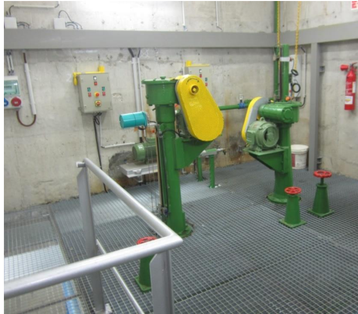
Foto 8. Vista de la cambra de vàlvules del desguàs de mig fons. Nivell superior.
