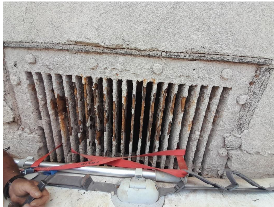
Foto 3. Estat actual de la reixa dreta del desguàs de mig fons
