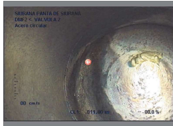
Foto: 2_2_12_A.jpg 11,8m, INFILTRACION EN LA CONDUCCION CHORREO CONTINUO , POR VALVULA DMF2
