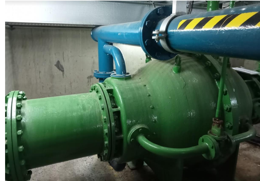
Fotografia 7 Vàlvula de regulació actual, de Larner-Johnson amb by-pass i tub d'aireació a la sortida de la vàlvula aigües avall (tub blau)
