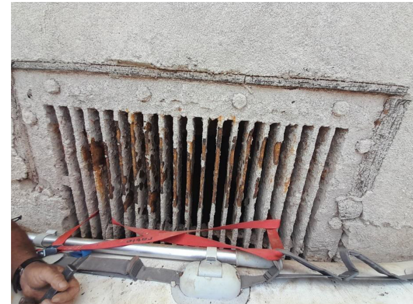
Fotografia 3 Estat actual de la reixa dreta.
