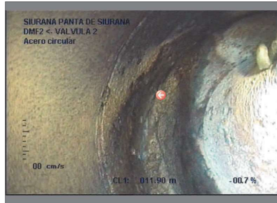
Foto: 2_2_12_B.jpg 11,8m, INFILTRACION EN LA CONDUCCION CHORREO CONTINUO , POR VALVULA DMF2
