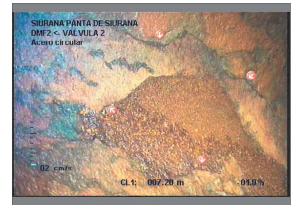
Foto: 2_2_11_B.jpg 7m, EL REVESTIMIENTO INTERIOR DE LA CONDUCCION EMPIEZA A DESPRENDERSE , EN UN 100%
