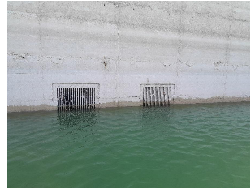
Fotografia 16 Reixes a l'embocadura dels DMF
