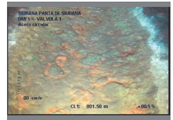
Foto: 1_1_7_B.jpg 1,5m, EL REVESTIMIENTO INTERIOR DE LA CONDUCCION EMPIEZA A DESPRENDERSE
