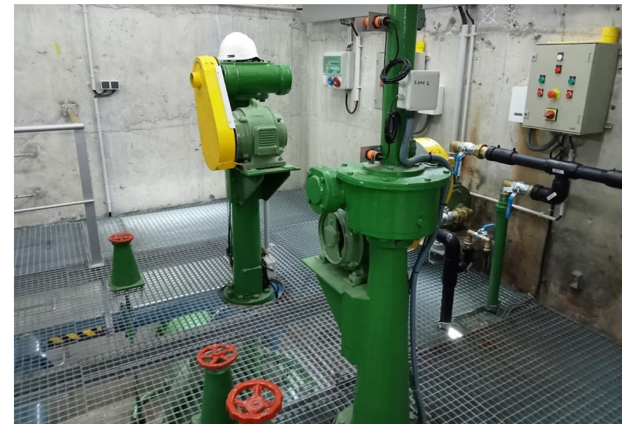
Fotografia 4 Zona superior de la cambra de vàlvules dels DMF de mig fons de la presa de Siurana. En primer terme l'accionament de la vàlvula de comporta i en segon terme la vàlvula de regulació Larner-Johnson. A l'esquerra de la imatge i al fons es pot veure la barana d'accés a la part inferior, amb pates ancorats a la paret.
