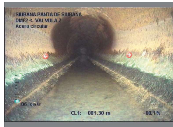
Foto: 2_2_9_A.jpg 1,3m, EL REVESTIMIENTO INTERIOR DE LA CONDUCCION EMPIEZA A DESPRENDERSE , DE UN 40%
