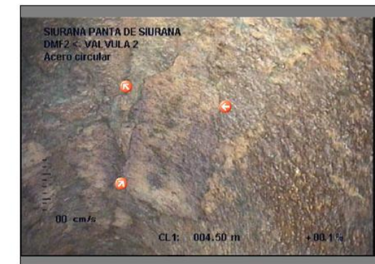
Foto: 2_2_10_B.jpg 3,8m, EL REVESTIMIENTO INTERIOR DE LA CONDUCCION EMPIEZA A DESPRENDERSE , EN UN 100%
