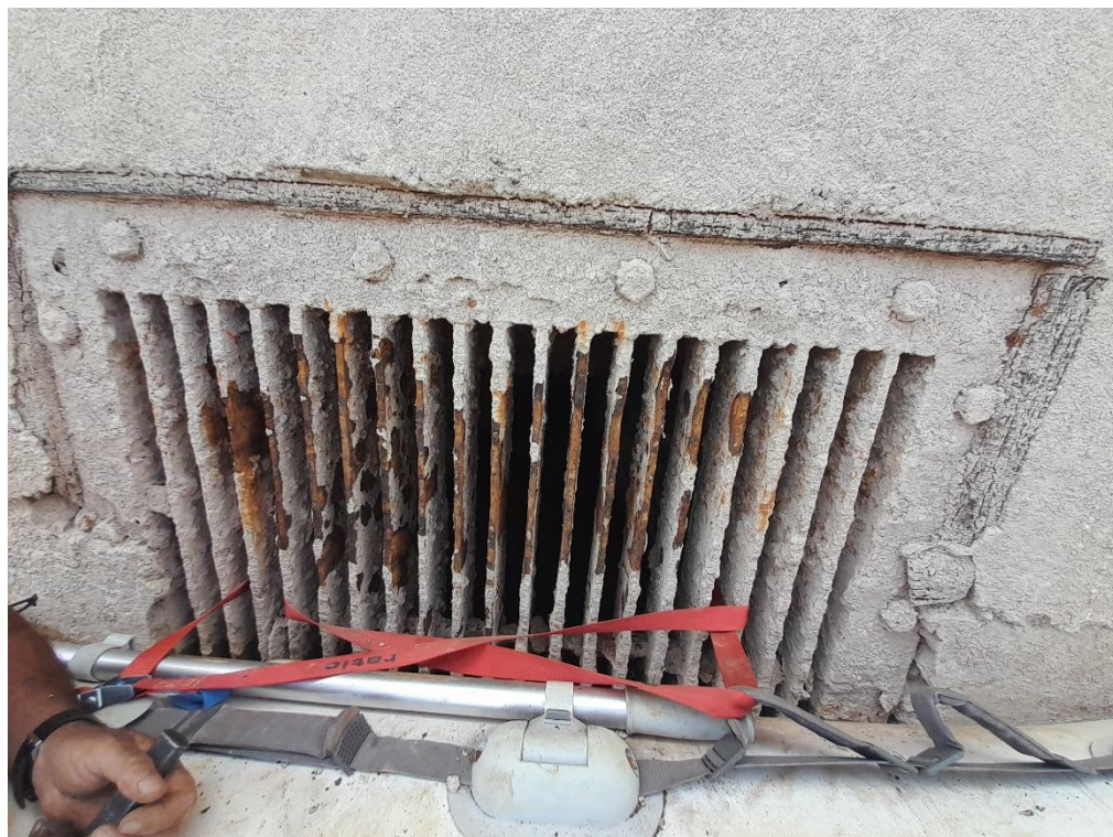
Fotografia 18 Estat actual de la reixa dreta.
