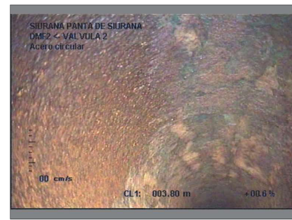
Foto: 2_2_10_A.jpg 3,8m, EL REVESTIMIENTO INTERIOR DE LA CONDUCCION EMPIEZA A DESPRENDERSE , EN UN 100%
