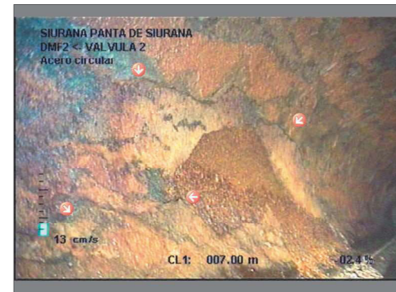
Foto: 2_2_11_A.jpg 7m, EL REVESTIMIENTO INTERIOR DE LA CONDUCCION EMPIEZA A DESPRENDERSE , EN UN 100%
