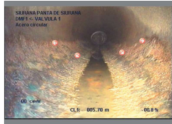
Foto: 1_1_8_A.jpg 5,7m, EL REVESTIMIENTO INTERIOR DE LA CONDUCCION EMPIEZA A DESPRENDERSE , un 40%
