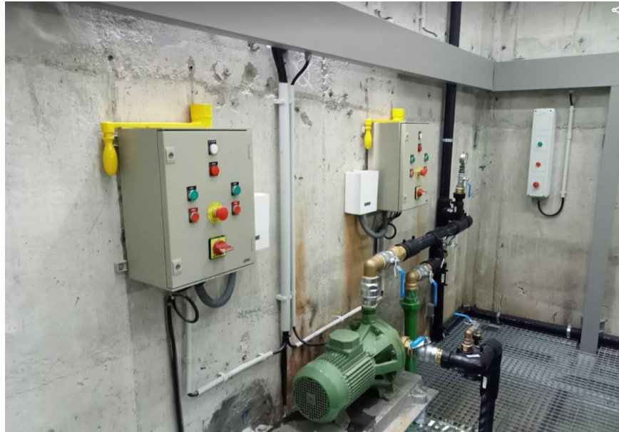
Fotografia 13 Bomba d'impulsió d'aigua de servei a la presa. Capta del by-pass de la comporta de seguretat de la línia dreta de DMF (mirant aigües avall) i impulsa a ambdós costats de la presa. A la paret els armaris de maniobra de les vàlvules de la línia dreta de DMF (mirant aigües avall)
