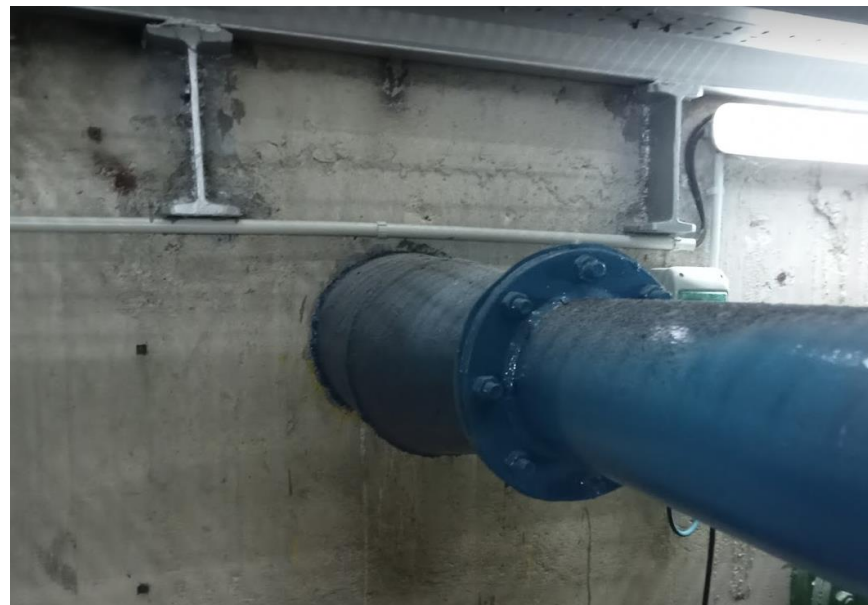
Fotografia 8 Sortida del tub d'aireació de la cambra dels DMF. El tub, de fossa de DN160 passa a DN300 a l'entrada en el formigó fins a la sortida en coronació de la presa.
