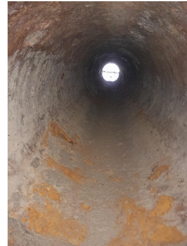
Foto 4. Estat actual del blindatge de la conducció aigües amunt de la cambra de vàlvules de DMF. Al fons s'observa la reixa de l'embocadura.
