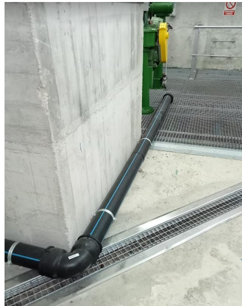
Fotografia 10 Sortida de la cambra de vàlvules cap a la galeria de presses d'aigua de la canonada provisional de l'abastament al Topograpo.
