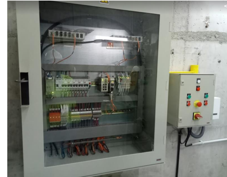
Fotografia 15 Armari elèctric, de control i automatització de les vàlvules de regulació i seguretat dels DMF
