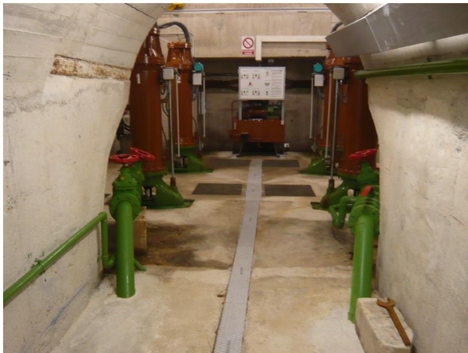
Foto 3. Vista de la cambra de vàlvules del desguàs de fons.
