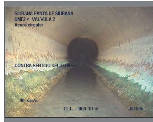
Foto: 2_1_2_13072023_123048_A.JPG 0m, CONTRA SENTIDO DEL FLUIDO
