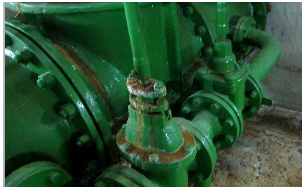
Foto 12. Aspecte del bypass de la vàlvula de comporta.
