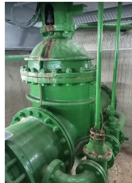
Fotografia 6 Vàlvula de comporta, de seguretat amb by-pass
