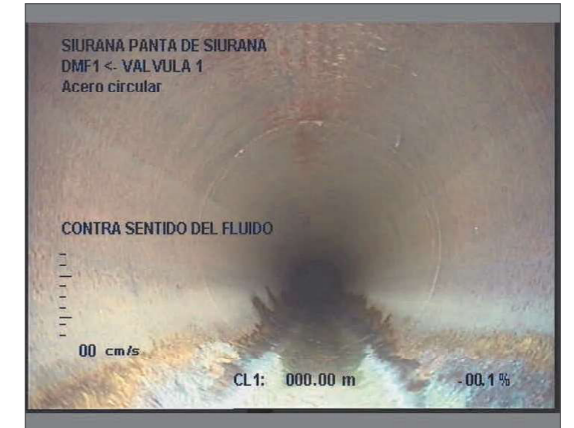
Foto: 1_1_2_13072023_120759_A.JPG 0m, CONTRA SENTIDO DEL FLUIDO
