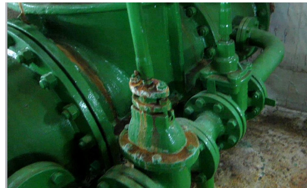
Foto 2. Aspecte del bypass de vàlvula de comporta
