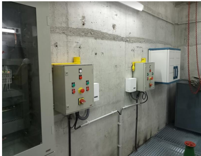
Fotografia 14 A la paret els armaris de maniobra de les vàlvules de la línia esquerra de DMF (mirant aigües avall)
