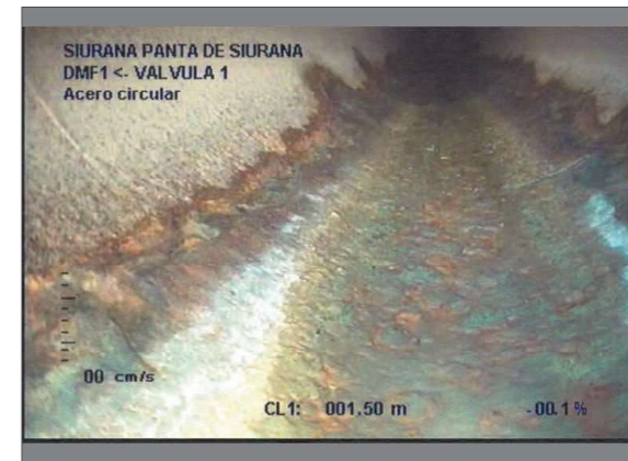
Foto: 1_1_7_A.jpg 1,5m, EL REVESTIMIENTO INTERIOR DE LA CONDUCCION EMPIEZA A DESPRENDERSE
