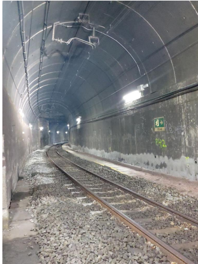
Imatge 6 - Catenària flexible a renovar en túnel Viladordis
