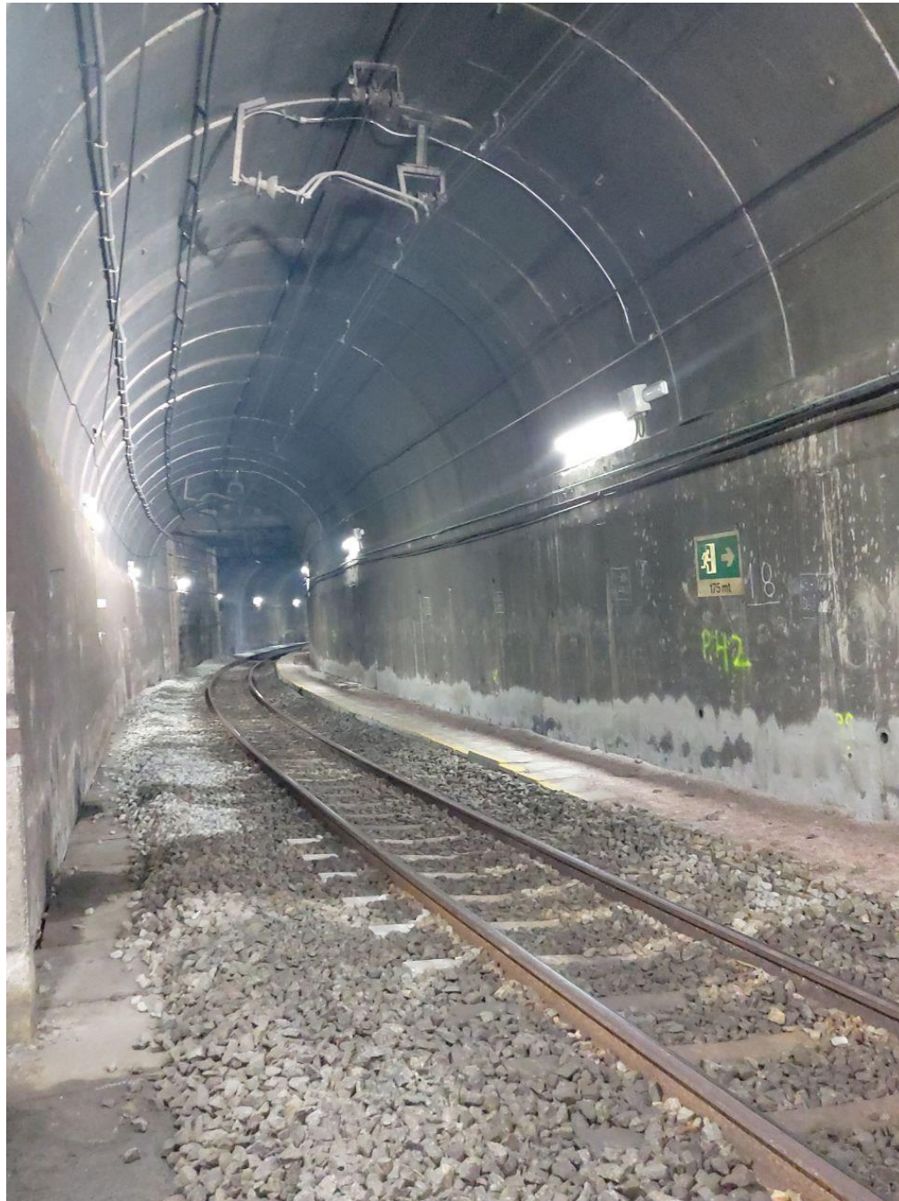
Fotografia 13 - Zona túnel amb volta formido regular, suport Ca 2-1 per sustentador allargat i Ca4-1 de feeder. Connexions a terra dels suports atirantat i suspensió
