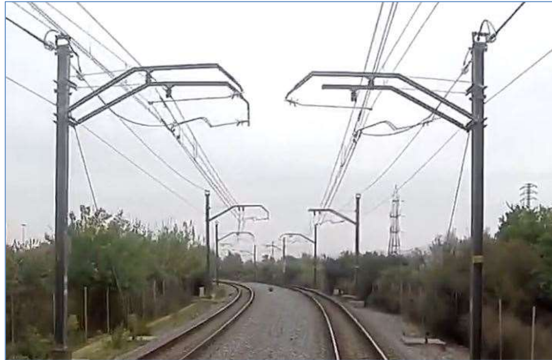
Fotografia 9 - Costat Sant Boi – Molí Nou. Punts d'alimentació de feeders a catenària de vies 1 i 2 a làmina d'aire.
