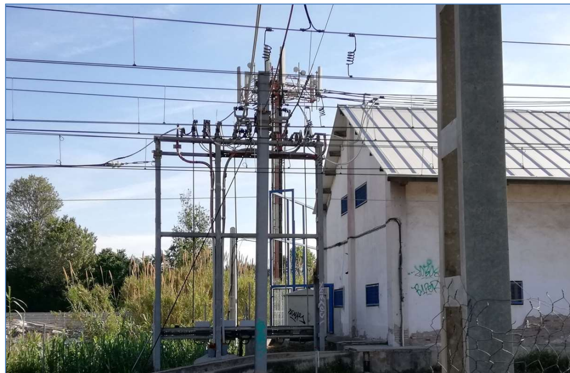
Fotografia 3 – Estació Sant Boi. Pòrtic seccionador subcentral i creuament de feeder d'alimentació a catenària.
