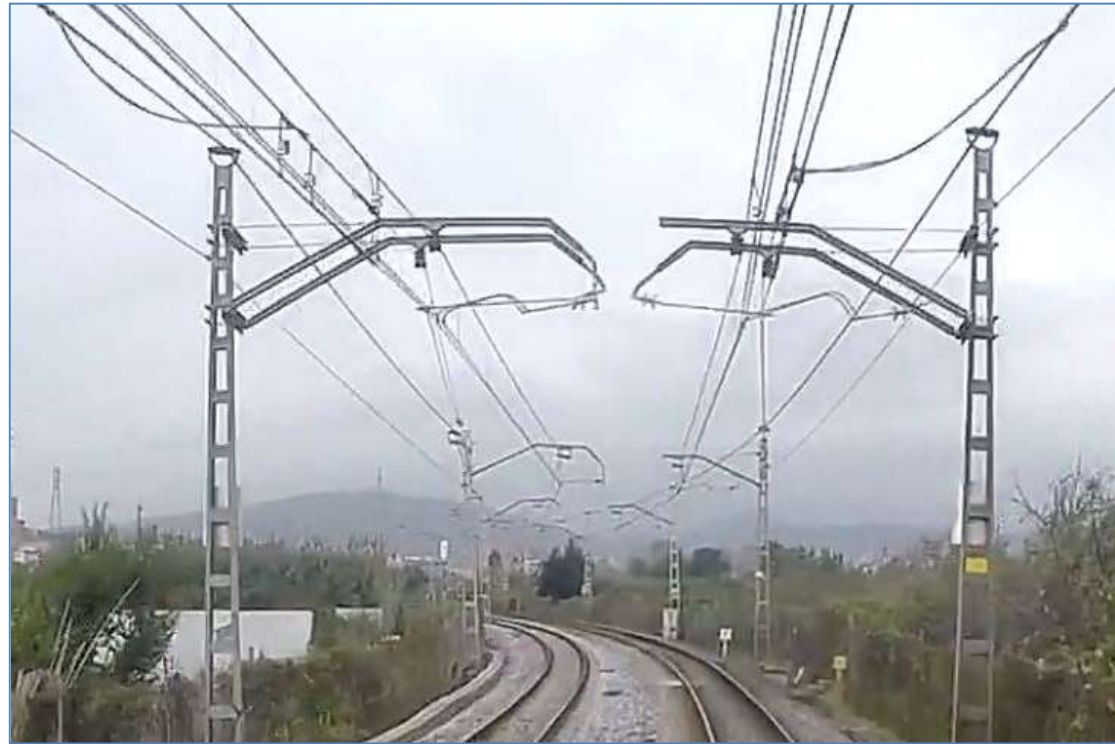
Fotografia 5 - Costat Sant Boi – Cornellà. Punt d'alimentació feeders a catenària.
