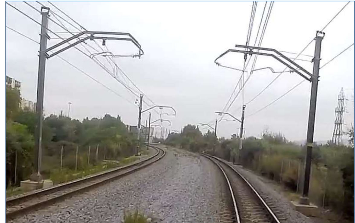
Fotografia 10 - Costat Sant Boi – Molí Nou. Làmina d'aire de vies 1 i 2.
