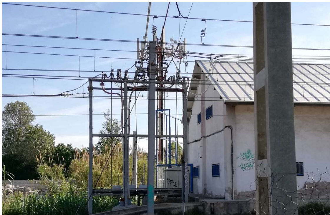
Imatge 1 – Pòrtic feeders subcentral Sant Boi
