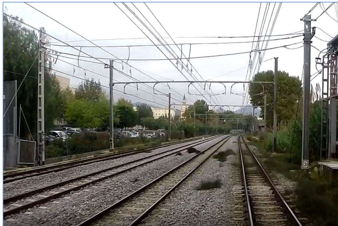
Fotografia 7 - Estació Sant Boi. Alimentacions de vies d'estació des de pòrtic subcentral.
