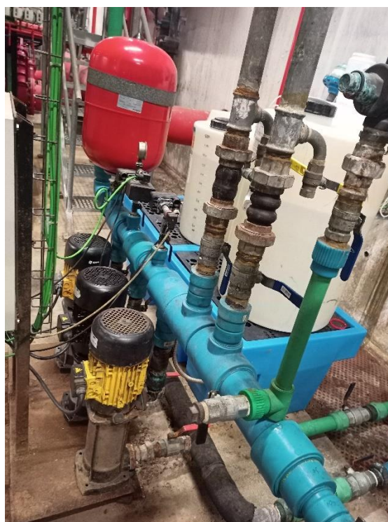
VISTA COL·LECTOR AIGUA DESCALCIFICADA
