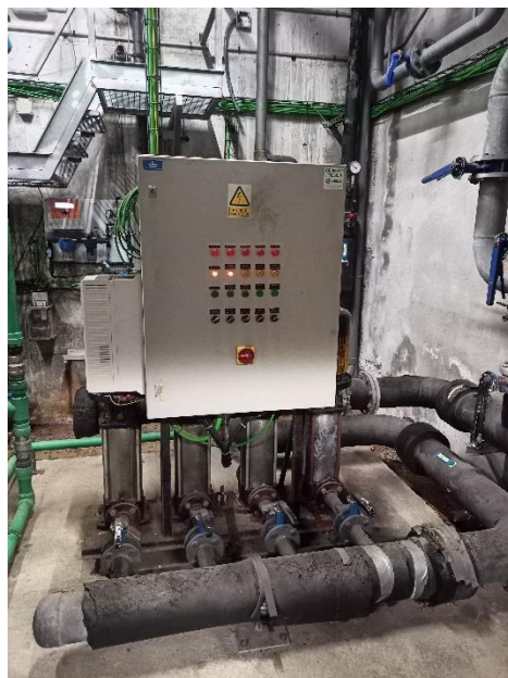
VISTA GRUP DE PRESSIÓ AIGUA FREDA SANITARIA
