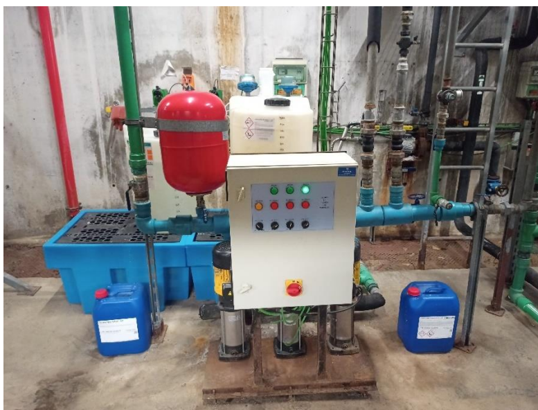
VISTA GRUP DE PRESSIÓ D'AIGUA DESCALCIFICADA
