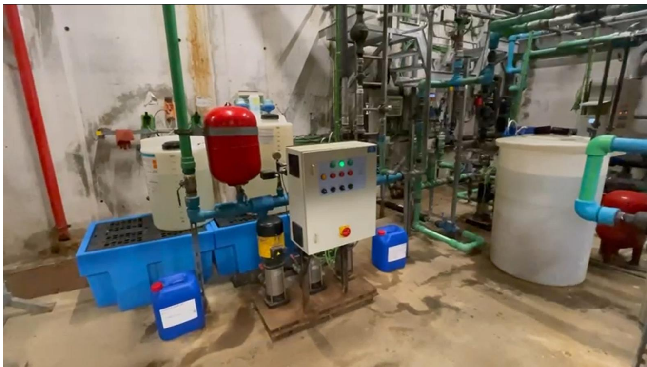
VISTES GENERALS DE SALA DE GRUPS DE PRESSIÓ
