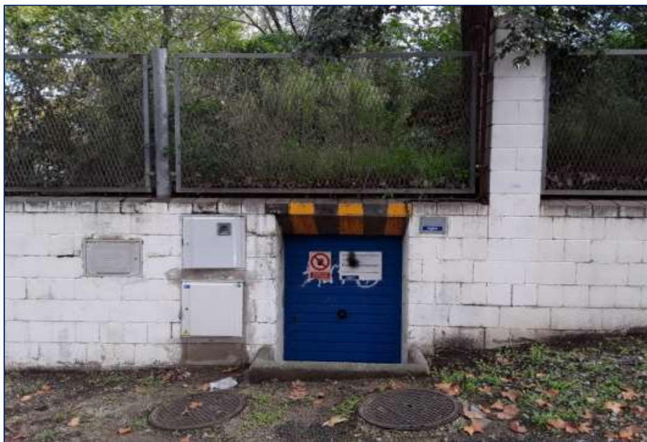
Figura 15. Vista de l'entrada al grup de pressió de l'avinguda del Parc
