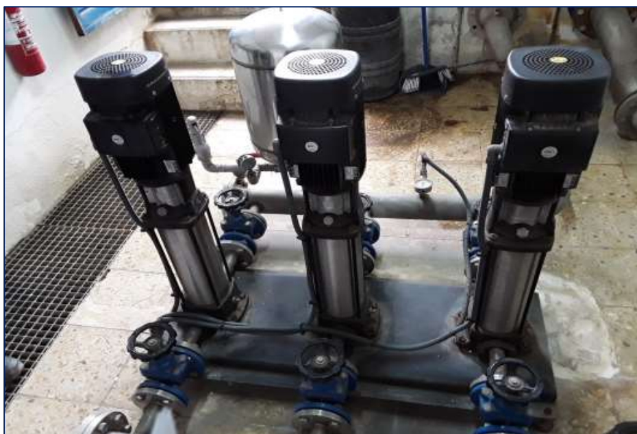
Figura 16. Vista interior del grup de pressió de l'avinguda del Parc amb les bombes corresponents
