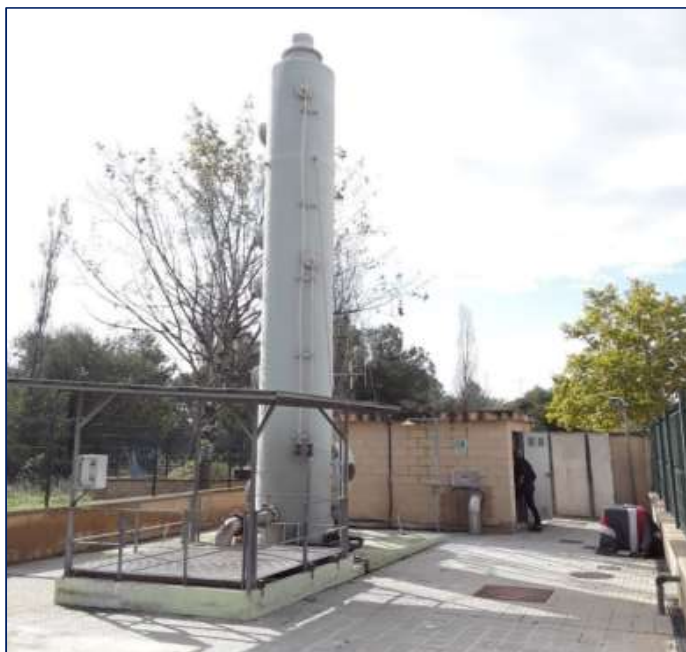
Figura 4. Vista general de la planta de stripping
