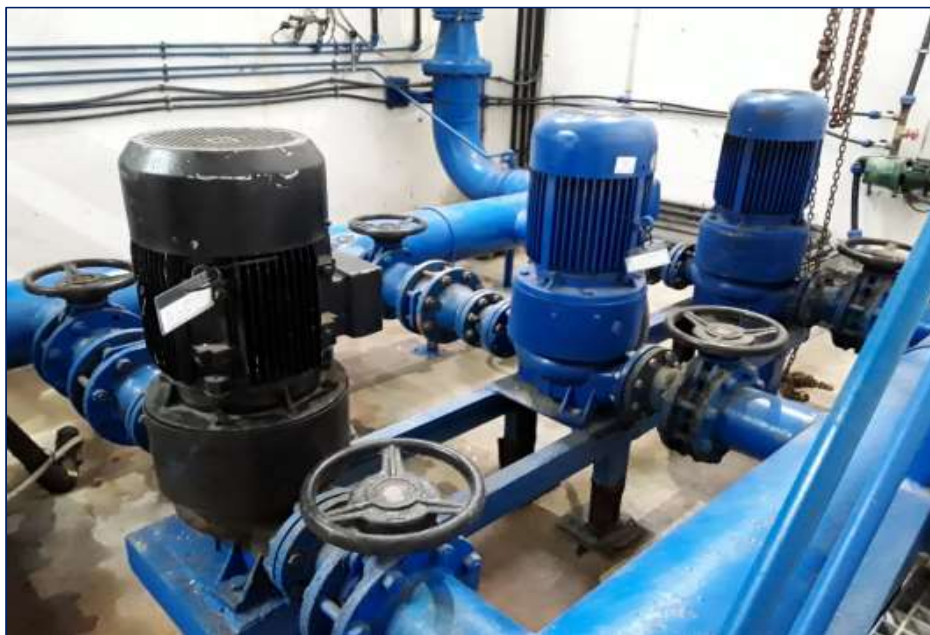
Figura 14. Vista interior amb les bombes de l'estació d'elevació del Cementiri
