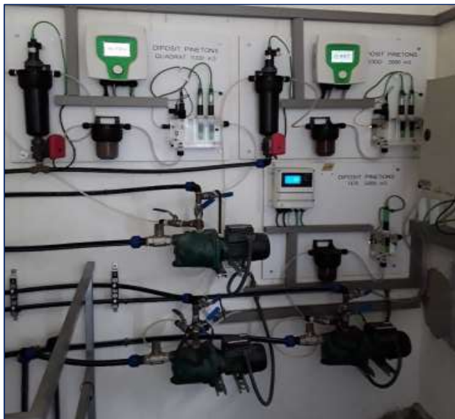
Figura 8. Vista interior de la sala de claus i valvuleria amb el sistema de cloració dels dipòsits de Pinetons
