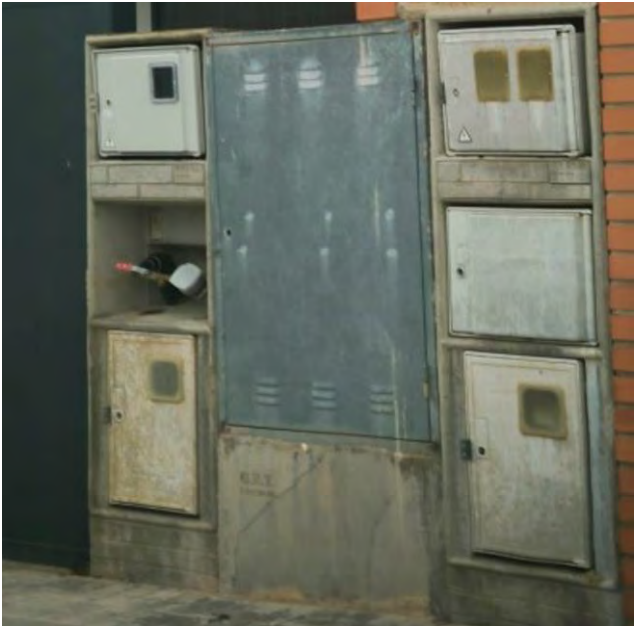
Caixa amb comptador a l'interior sense portella
