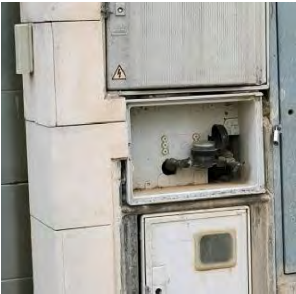
Caixa amb comptador a l'interior sense portella
