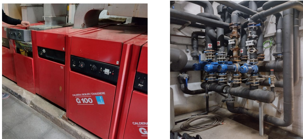
Figura 2 i 3: Calderes de gas i els 4 circuits de distribució de calor
