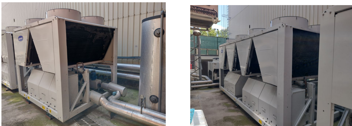
Figura 4 i 5: Màquines de refrigeració
