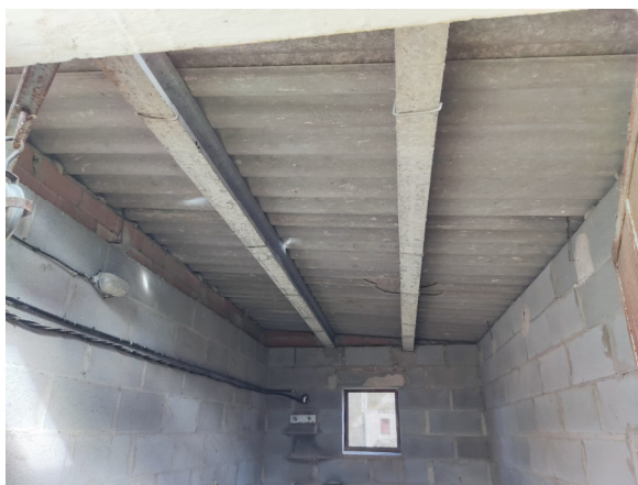
Fotografia 2 Estat actual del sostre de la caseta
