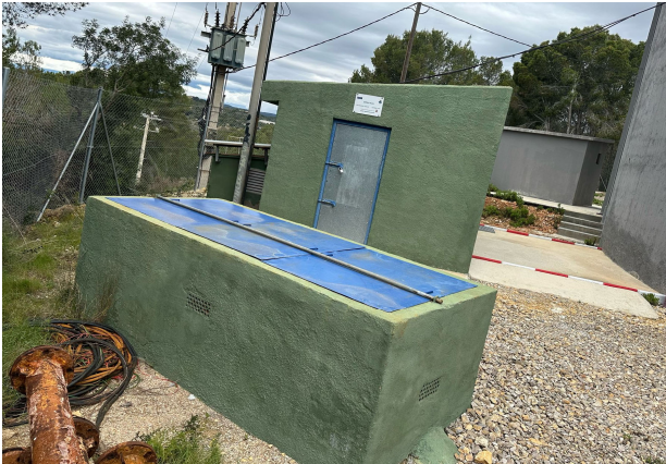
Foto 3.- Arqueta existent del pou 2
