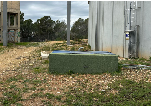
Foto 2.- Arqueta existent del pou 1
