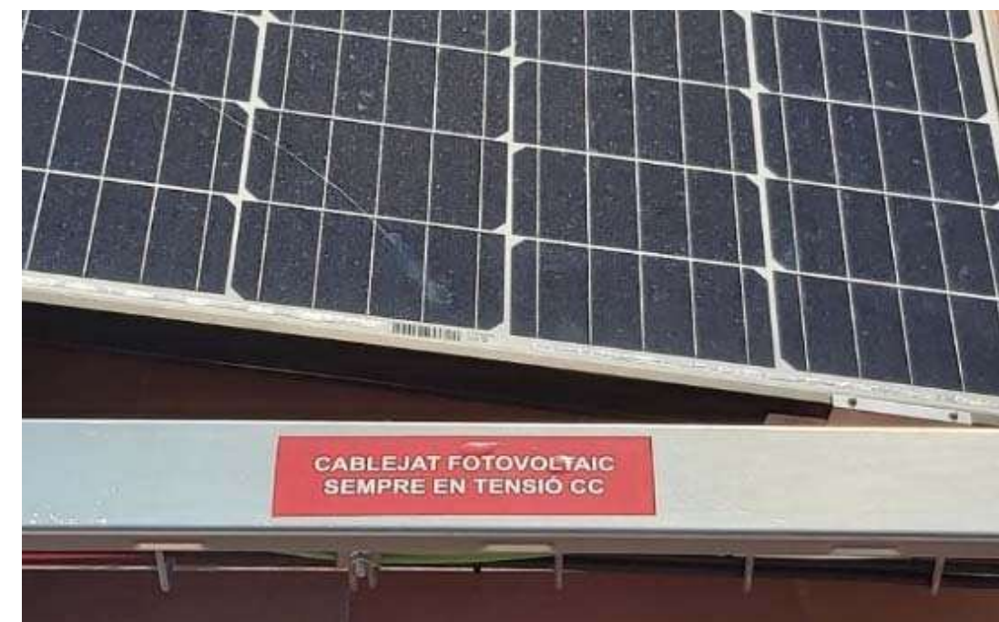
Imatge 82. Exemple de safata metàl·lica per cablejat de CC
