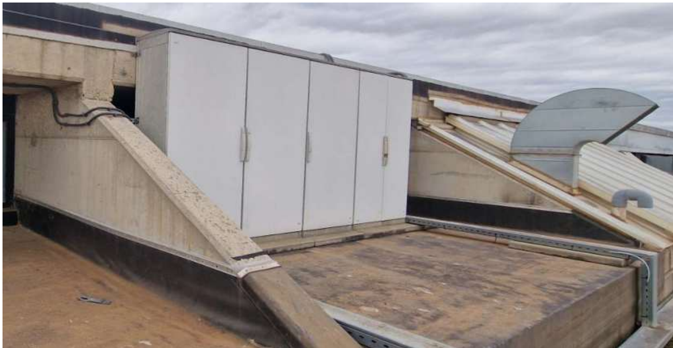
Imatge 80. Subquadre ventiladors coberta espina C
