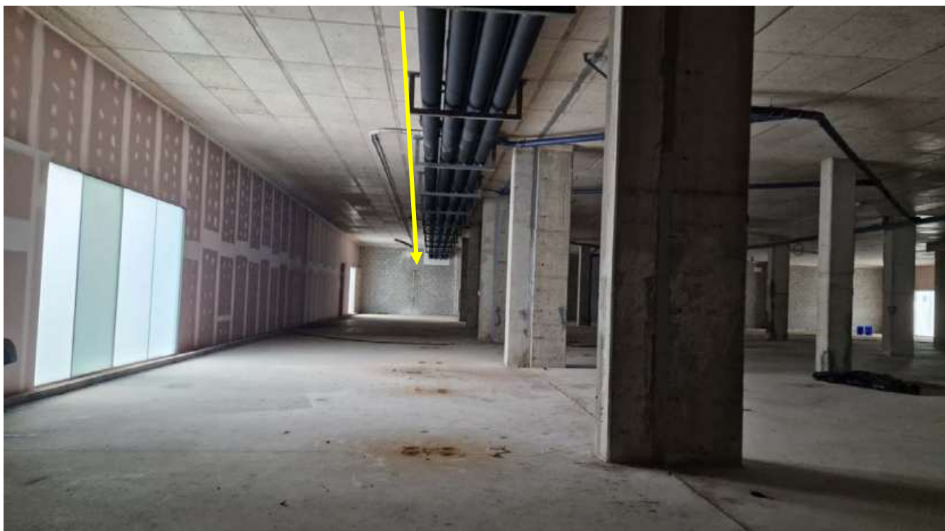
Imatge 73. Cablejat de CA per futur espai d'hemodiàlisis
