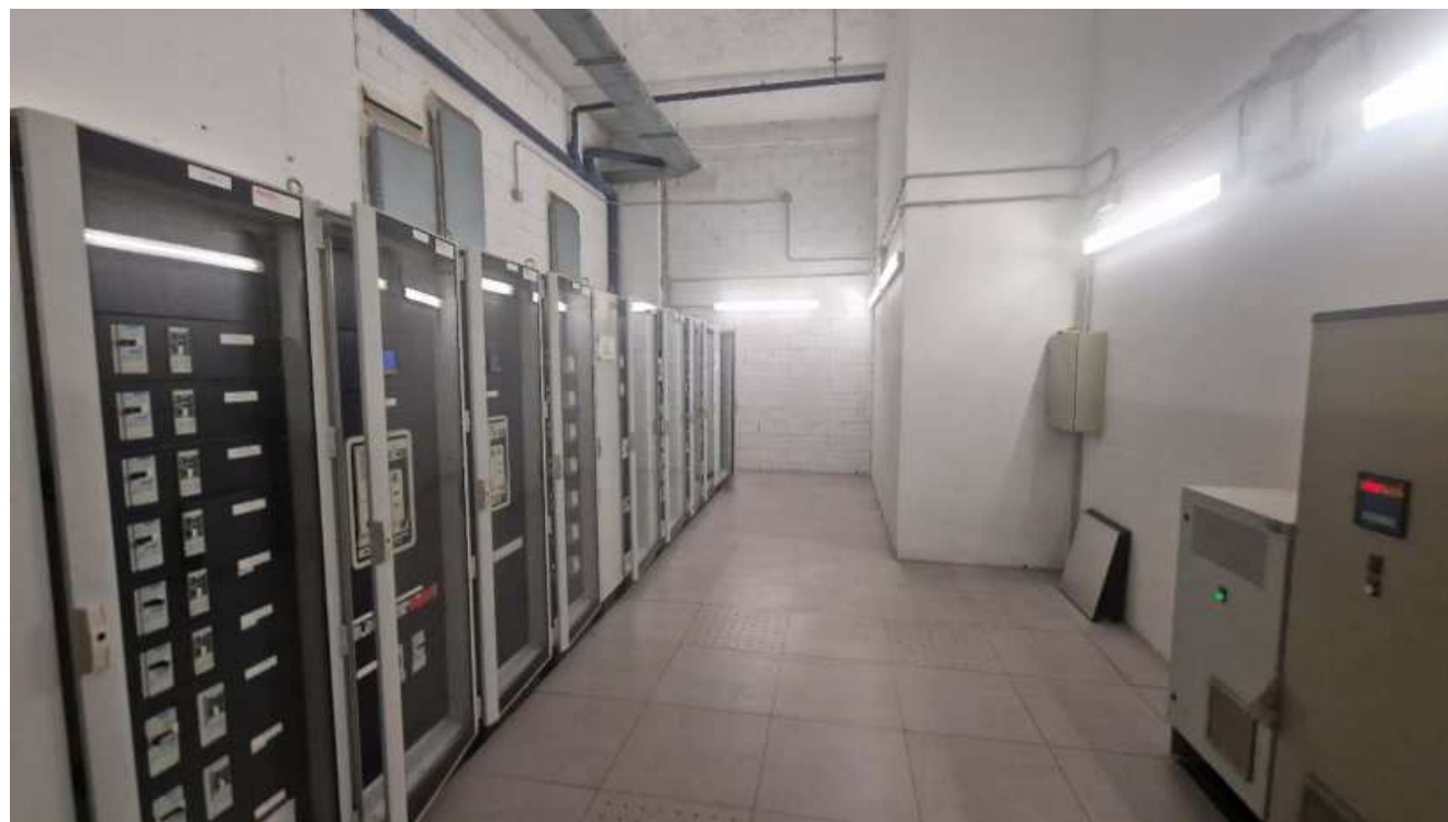
Imatge 6. Sala Tècnica ET2
