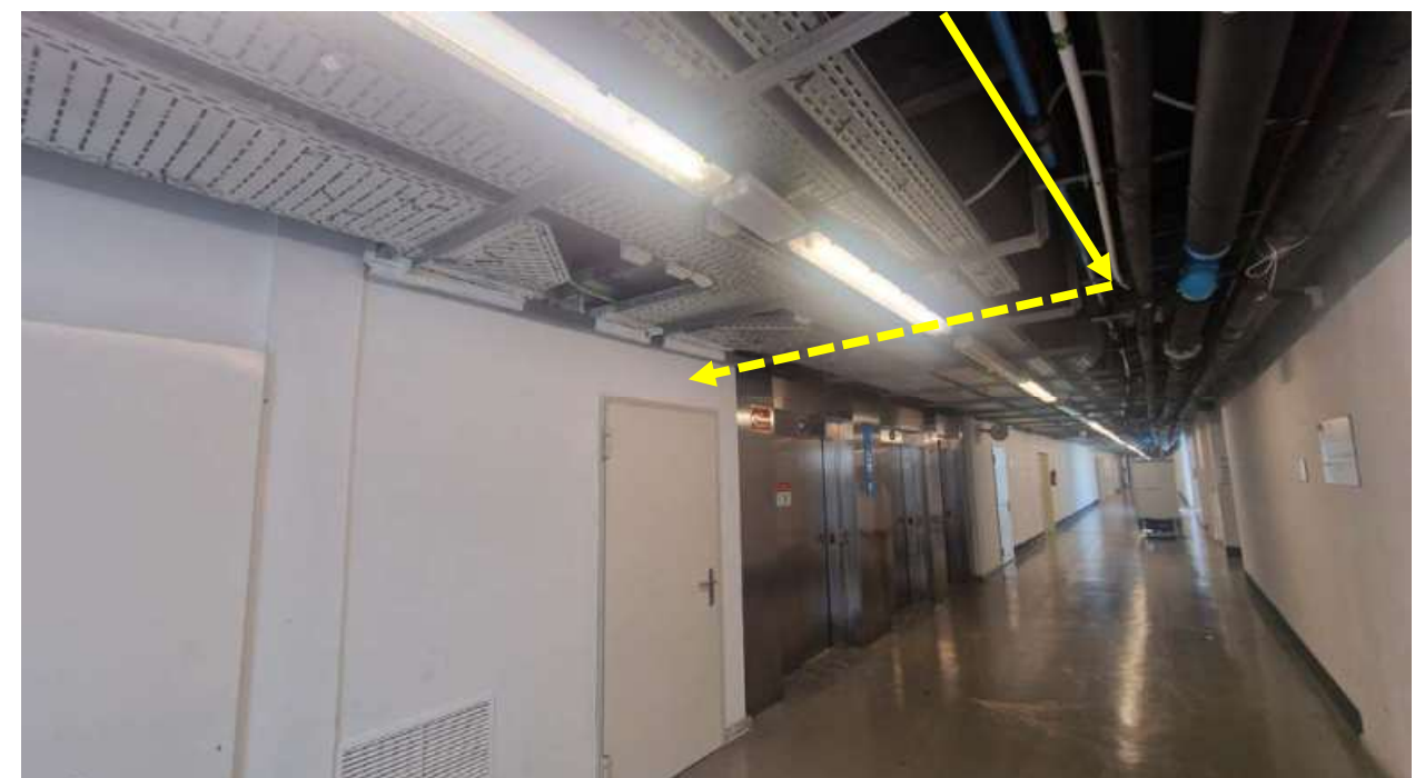
Imatge 56. Passadís d'espai tècnic a la ET1
