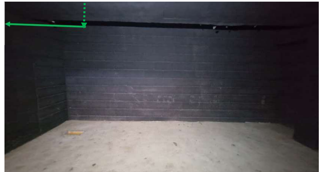
Imatge 68. Paret baixant de coberta fins cota planta baixa
