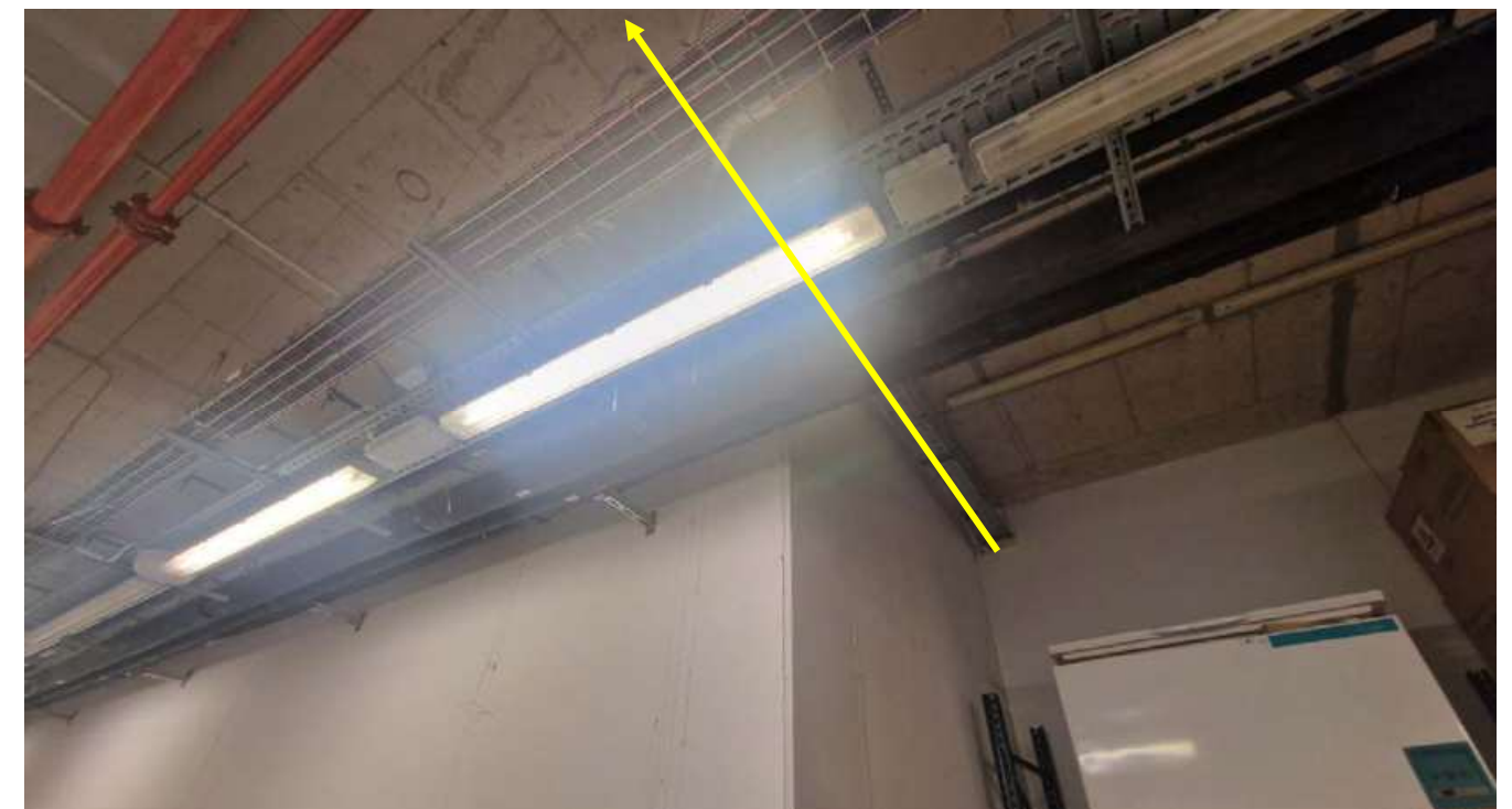
Imatge 72. Entrada cablejat a passadis de serveis provinent de l'aparcament
