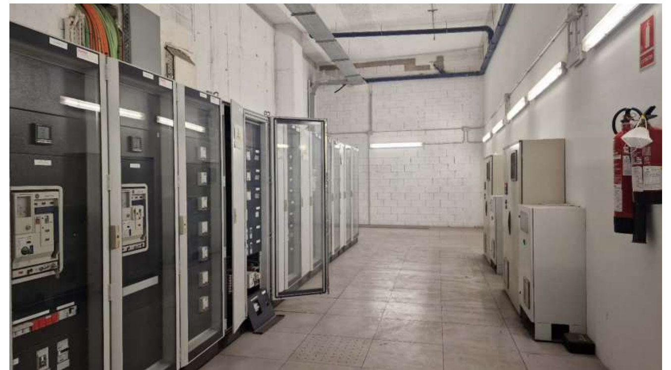
Imatge 7. Sala Tècnica ET1
