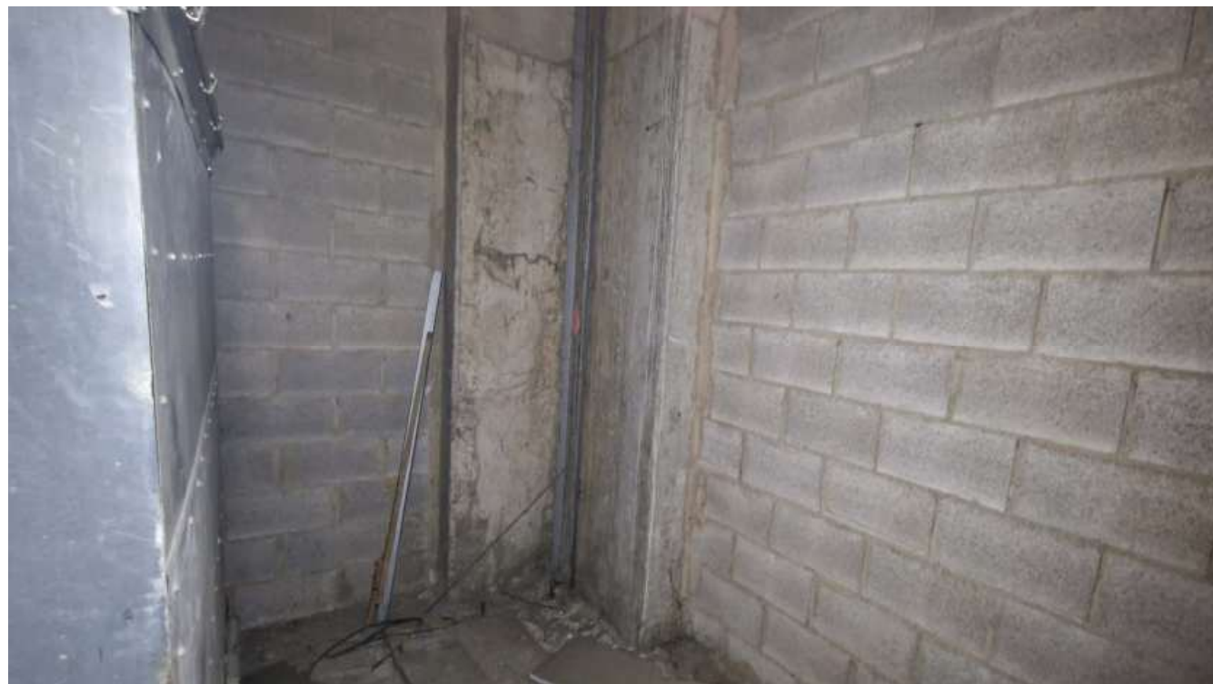
Imatge 70. Sala pendent d'obres on s'emplaçaran els inversors i les caixes de protecció de CC i CA
