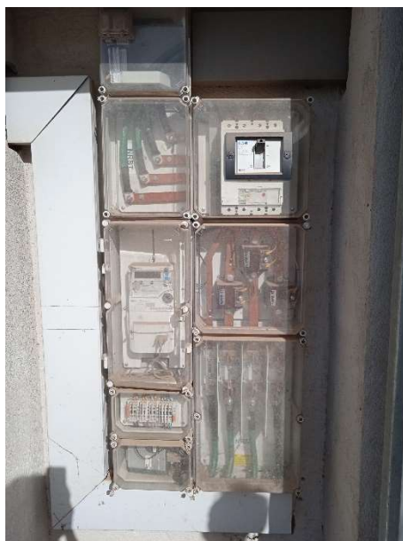
Imatge 8: Caixa de protecció i mesura de l'Escola Francesc Platón i Sarti
