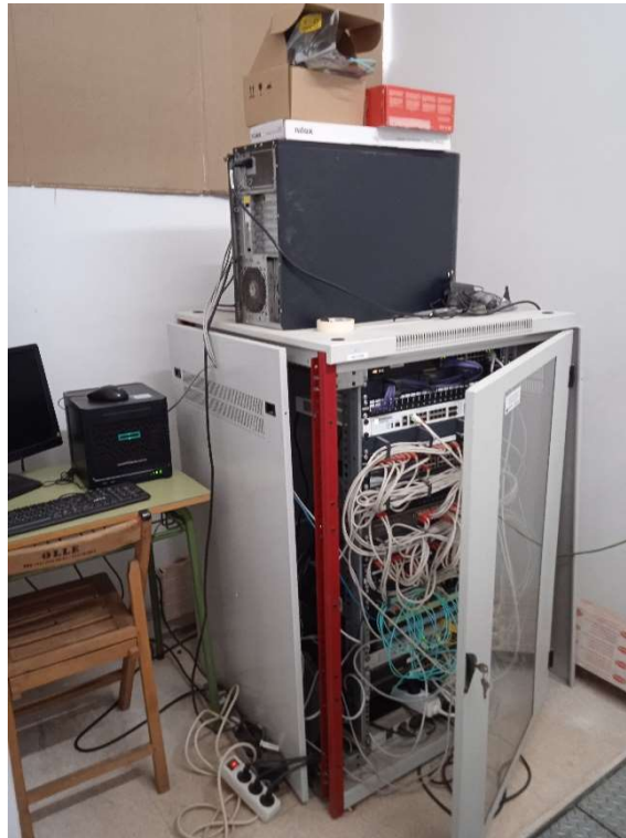
5. Punt de connexió a la xarxa de comunicacions
