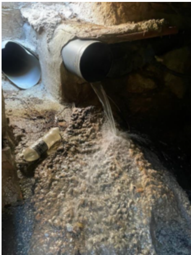
Foto 1: S'observa l'abocament d'aigües residuals directament al rial.
