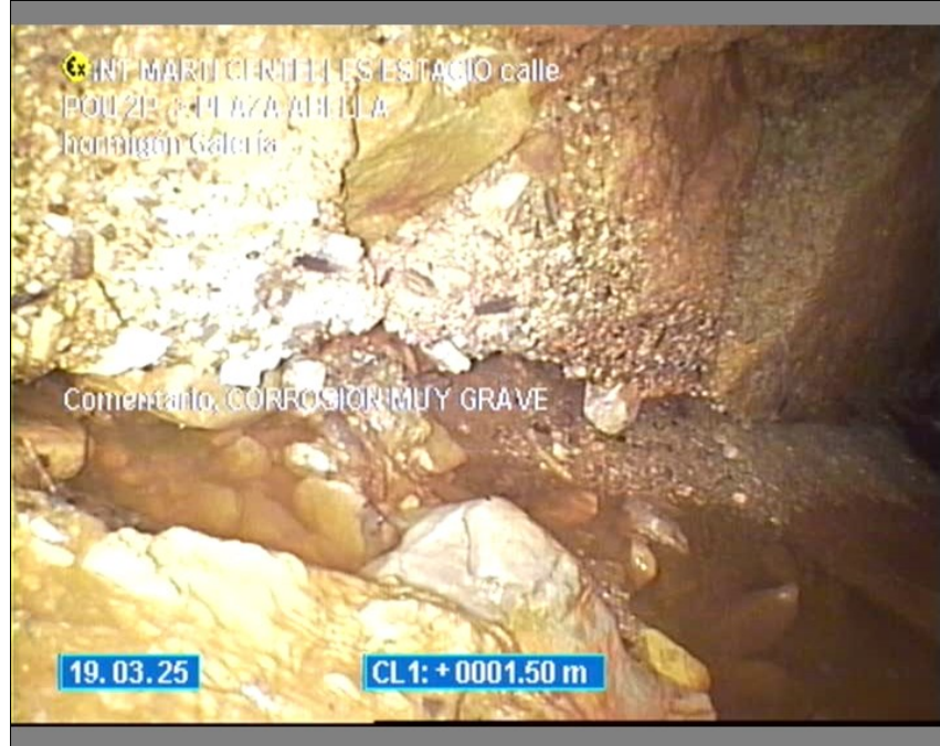
Foto: 10_2A, Medio N°: 190325_1, 00:00:21 1,5m, Comentario / CORROSION MUY GRAVE
