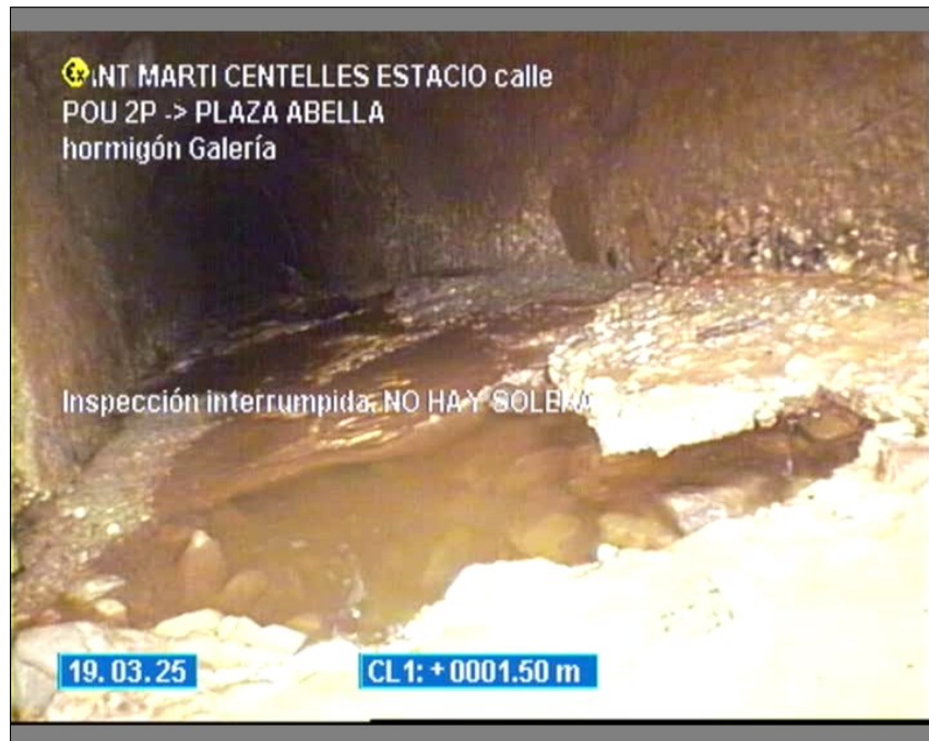
Foto: 10_3A, Medio N°: 190325_1, 00:00:37 1,5m, Inspección interrumpida / NO HAY SOLERA
