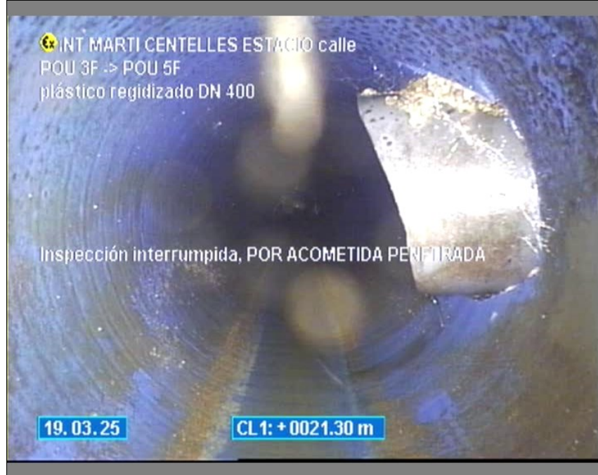
Foto: 1_2A, Medio N°: 190325_1, 00:01:32 21,3m, Inspección interrumpida / POR ACOMETIDA PENETRADA
