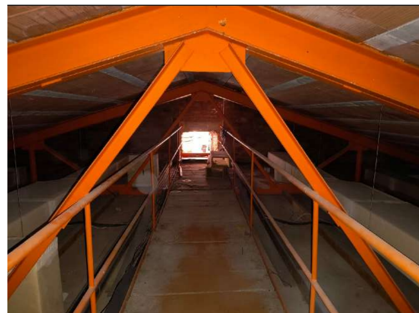
Falso techo salón de actos y pasarela de mantenimiento (al fondo trampilla de acceso desde cabina de proyecciones)
