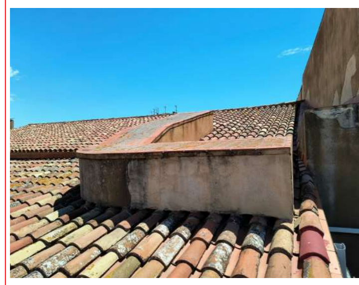
Tramo de conducto que discurre por cubierta a adecuar con aprovechamiento para estado proyectado
