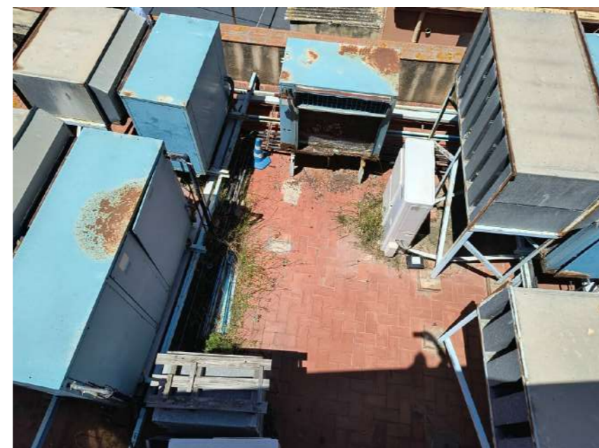
Vista desde cubierta de terraza con equipos existentes a sustituir (a excepción de unidad exterior de climatización de la marca Kosner)
