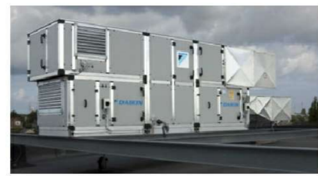
Unidad de tratamiento de aire Daikin
