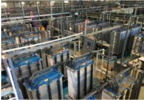
Imatge 1. Instal·lació EDR actual
