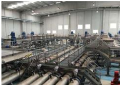
Imatge 3. EB previ filtres EDR actual
