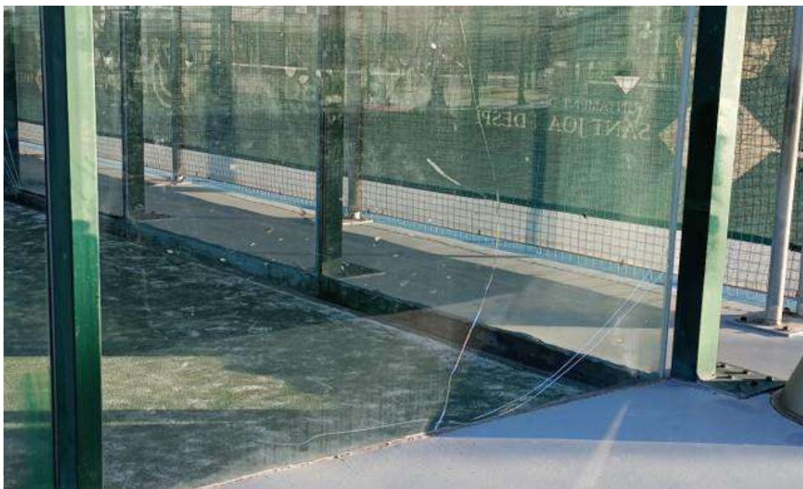
Desperfectes tancament pista de pàdel
