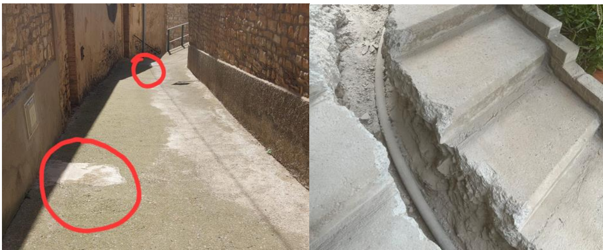
Figura 10: Tram a Vergós on es poden apreciar els arranjaments que s'han fet a la xarxa d'abastament a conseqüència de les avaries
